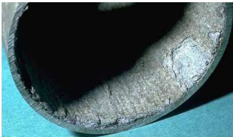
Slika 4 - Primjer selektivne korozije
