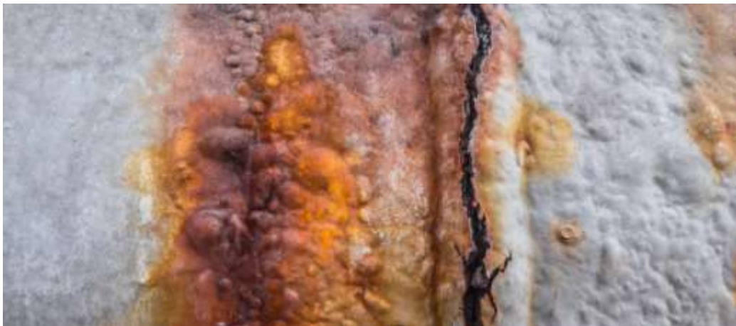
Slika 6 - Prikaz posljedice napetosne korozije
