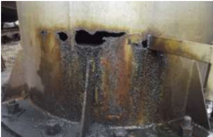
Slika 5 - Primjer rupičaste korozije na strojarskom elementu valjkastog oblika
