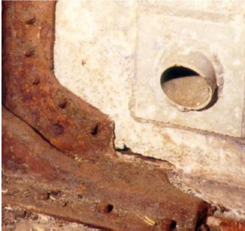
Slika 3: Galvanska korozija između aluminijskog i čeličnog elementa u dodiru [8]
