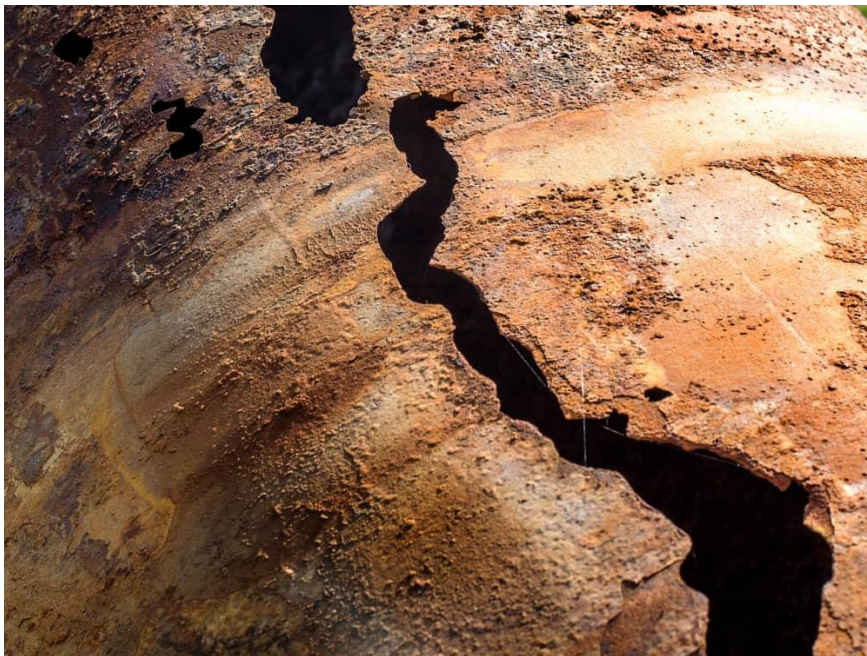
Slika 9: Oštećenje na cijevi zbog erozijske korozije [14]
