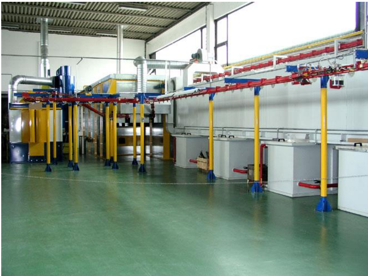
Slika 14: Pogon za plastifikaciju (elektrostatsko nanošenje prevlake u praškastom obliku) u tvrtci Dekor tvornica rasvjete d.o.o., Zabok – na slici je vidljiva komora za nanošenje praha, peć te lančani transporter za koji se vješaju obradci
