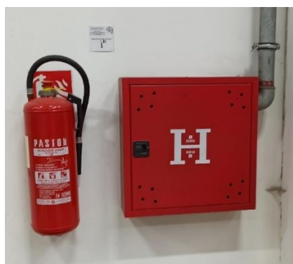
Slika 72 - Protupožarni aparat i priključak za vatrogasno crijevo
