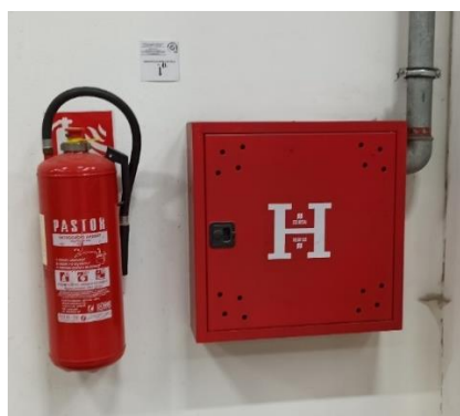
Slika 72 - Protupožarni aparat i priključak za vatrogasno crijevo
