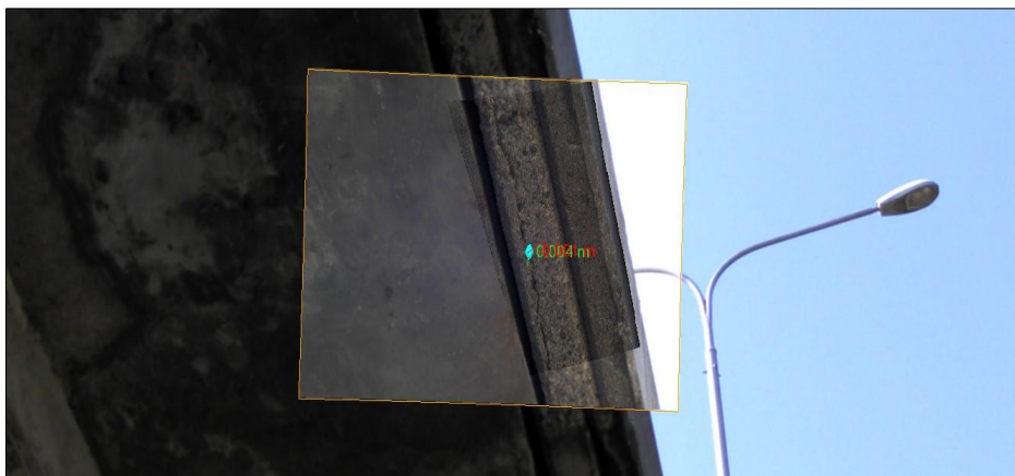
Slika 38. Oštećenje nastalo pod utjecajem vlage
