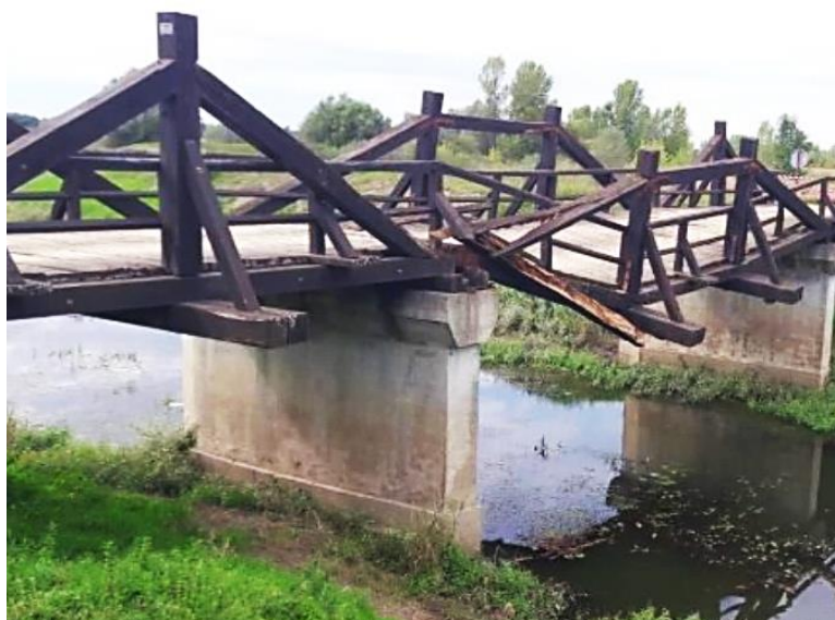
Slika 12. Oštećeni Črni most
