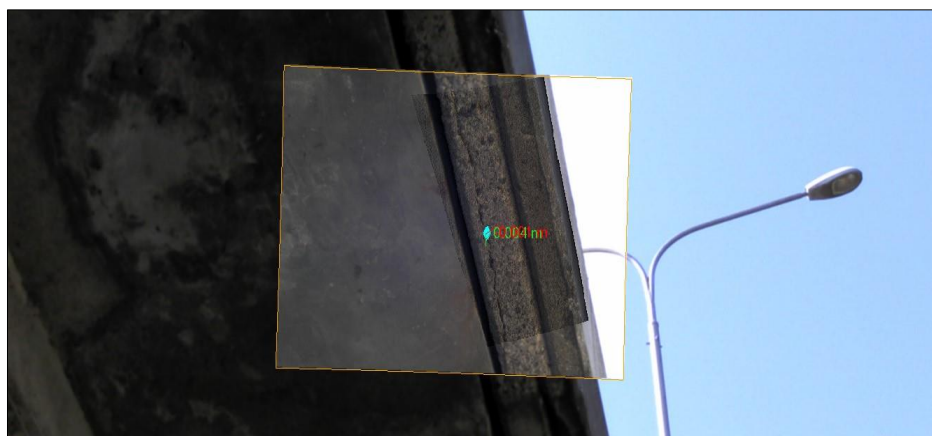
Slika 38. Oštećenje nastalo pod utjecajem vlage
