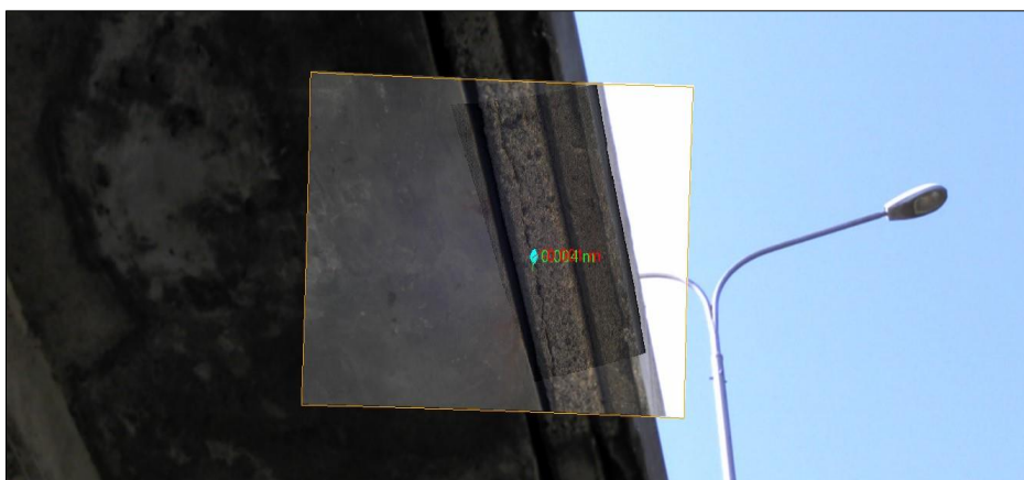
Slika 38. Oštećenje nastalo pod utjecajem vlage
