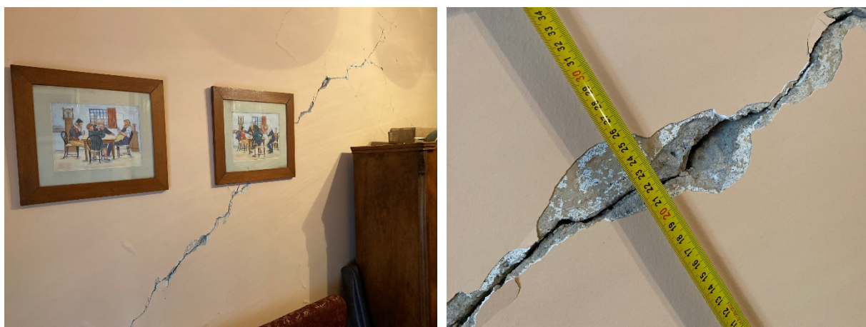
Slika 24. Dijagonalna pukotina južnog nosivog zida stana
