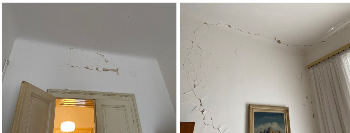
Slika 25. Formiranje lukova na zidovima desno, lijevo pukotina nadvoja
