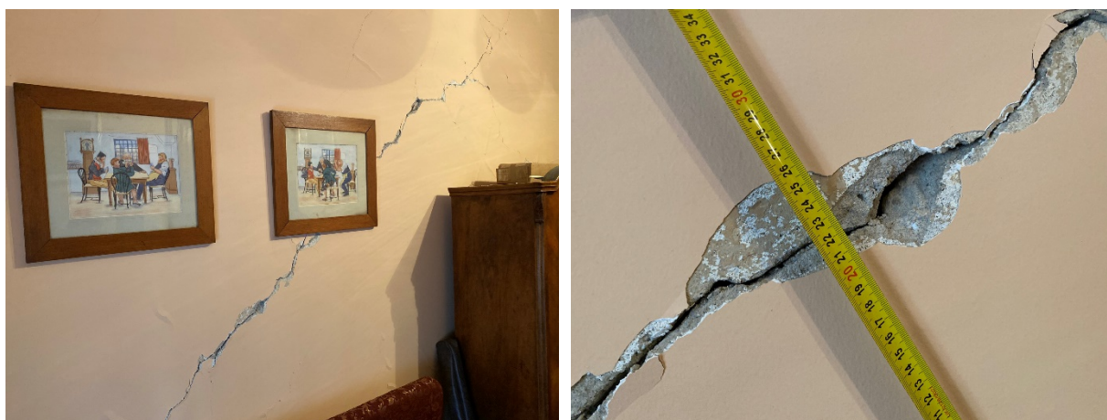
Slika 24. Dijagonalna pukotina južnog nosivog zida stana
