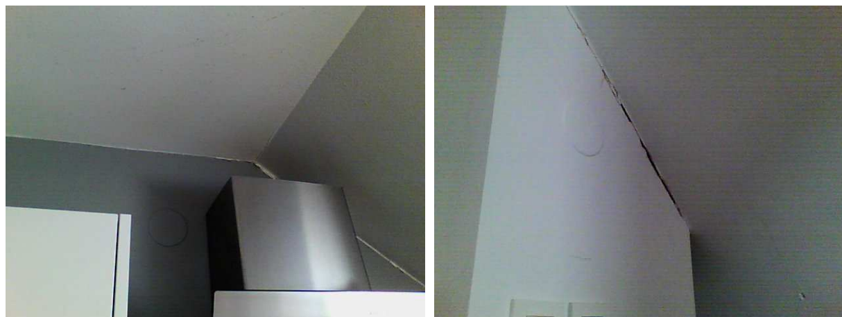
Slika 26. Pukotine gipskartonskih obloga
