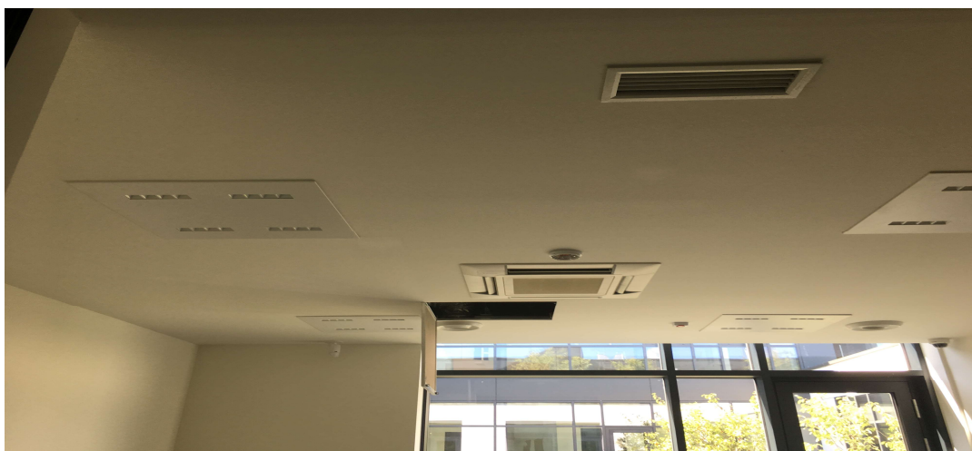
Slika 5.11 Spušteni strop – prizemlje dilatacija B
