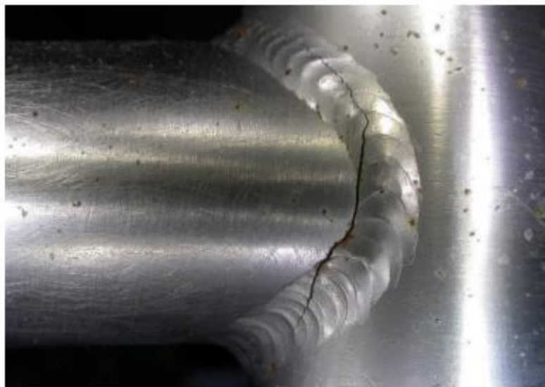
Slika 14. Pukotina otkrivena pomoću VT
