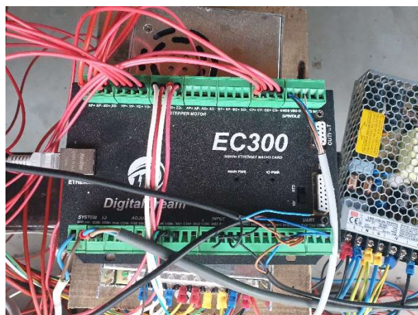
Slika 4.3 Probno spajanje CNC kontrolera
