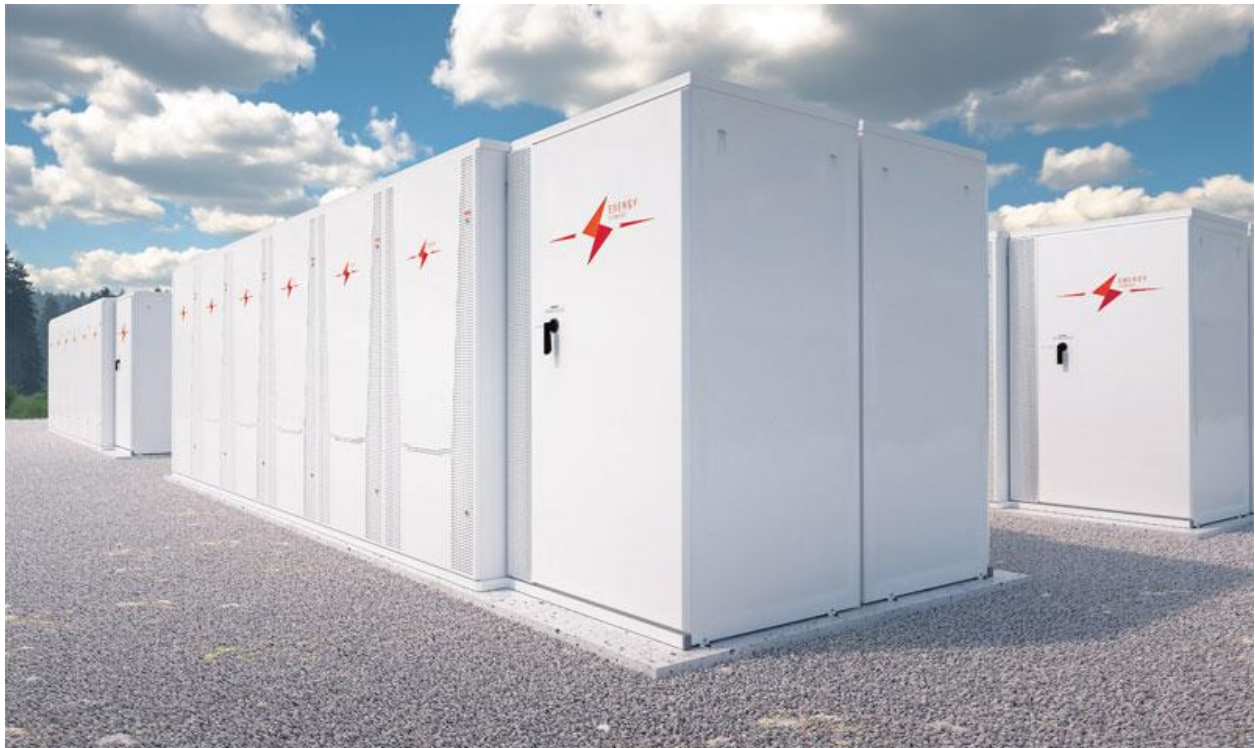
Slika 4.1 Postrojenje baterijskih spremnika [30]
