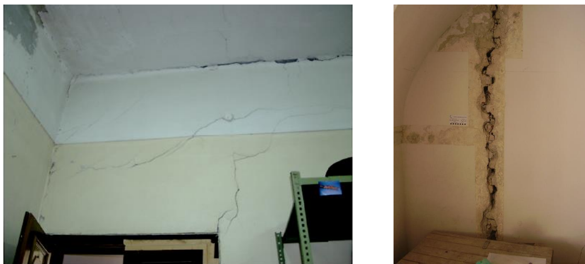
Slika 3.5 Pukotine na zidovima međukata
