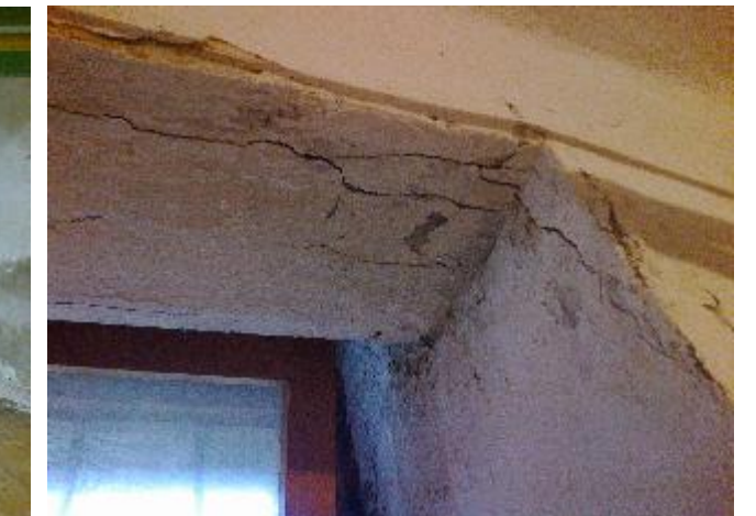
D. Sitne pukotine na nadvoju iznad prozora
