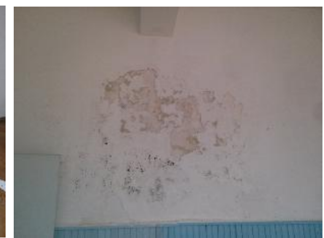
F. Pojava plijesni i otpadanje žbuke s unutarnjih zidova
