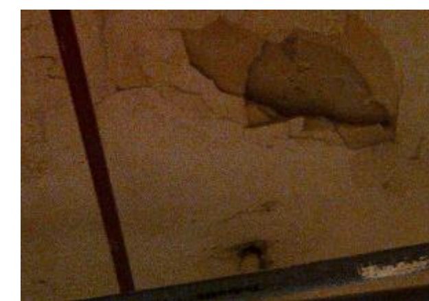
E. Otpadanje žbuke sa stropova podruma
