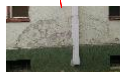
Prisutnost kapilarne vlage u vanjskom zidu prizemlja
