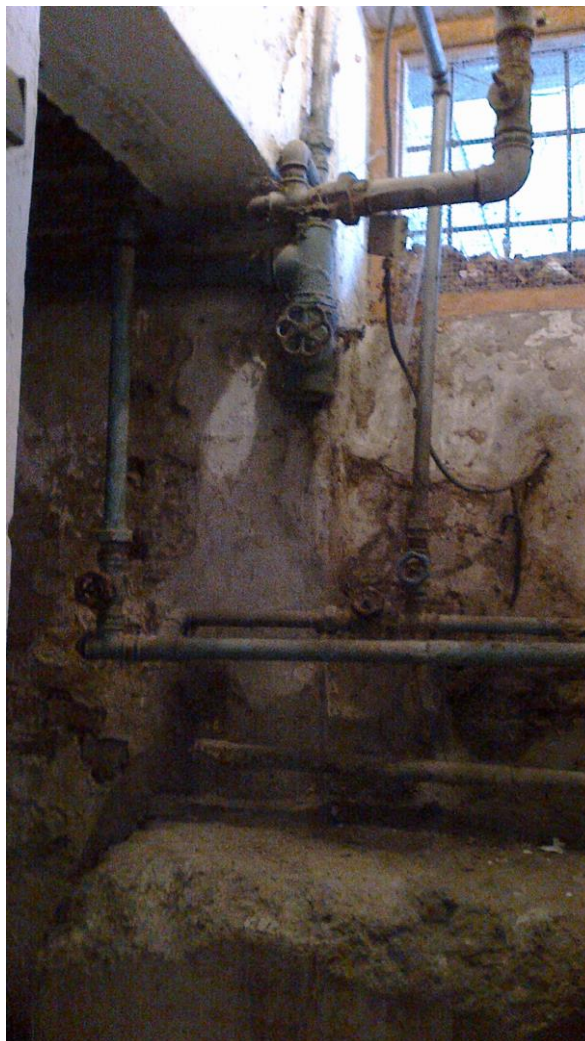
Slika 2.4 Dotrajale vodovodne instalacije predmetne zgrade
