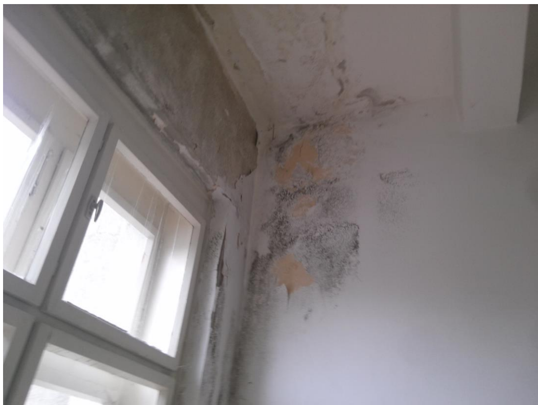
Slika 5.8 Pojava plijesni na zidovima i stropovima predmetne zgrade
