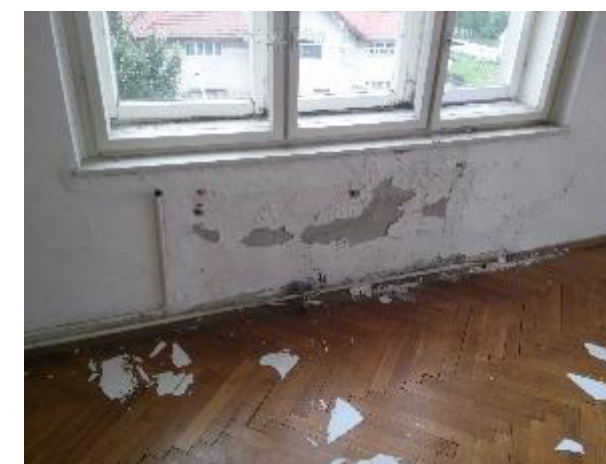
E. Otpadanje žbuke s vanjskog zida ispod prozora
