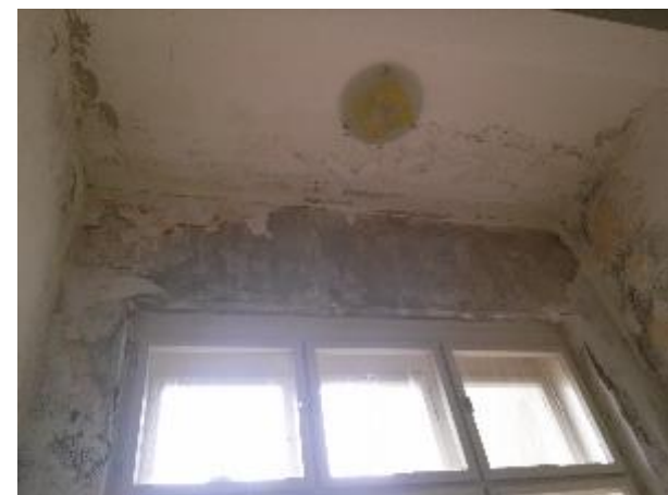
A. Otpadanje žbuke s vanjskog zida iznad prozora
