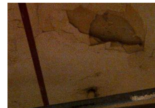
E. Otpadanje žbuke sa stropova podruma
