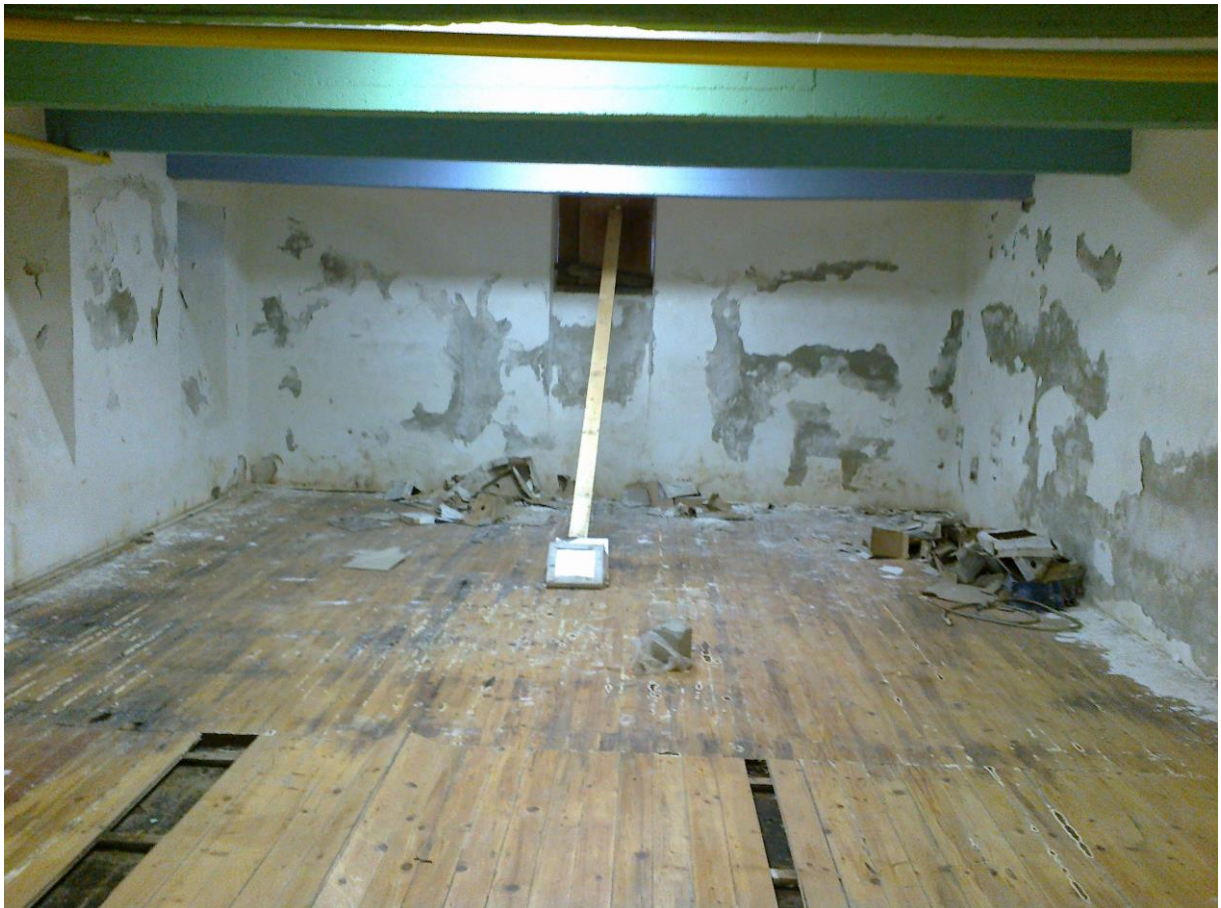
Slika 5.6 Drveni podovi u podrumu (parket u dvorani) su nabubрили i odvojili se od podloge
