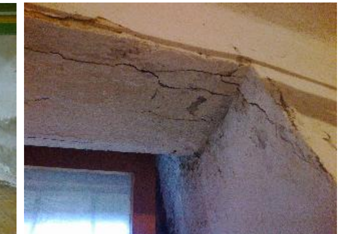
D. Sitne pukotine na nadvoju iznad prozora
