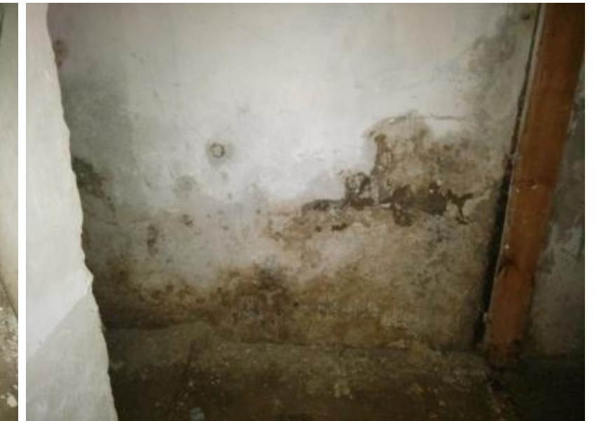
B. Kapilarna vlaga u zidovima
