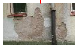
Oštećenje žbuke zbog prisutnosti kapilarne vlage
