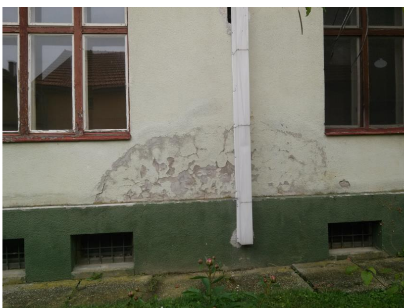
Slika 5.9 Oštećenja na ovojnici zgrade uslijed utjecaja vlage ostalih atmosferilija
