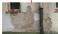
Oštećenje žbuke zbog prisutnosti kapilarne vlage
