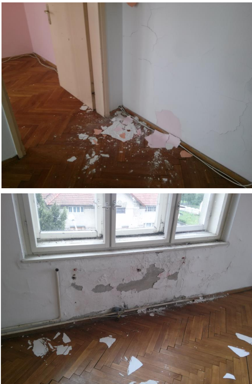
Slika 5.7 Žbuka na zidovima je ispucala i odvaja se od podloge
