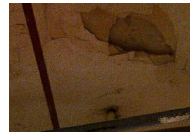
E. Otpadanje žbuke sa stropova podruma
