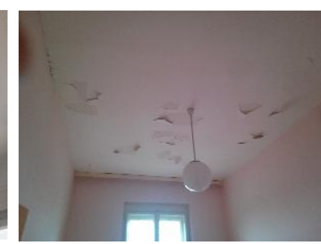
D. Otpadanje žbuke sa stropova
