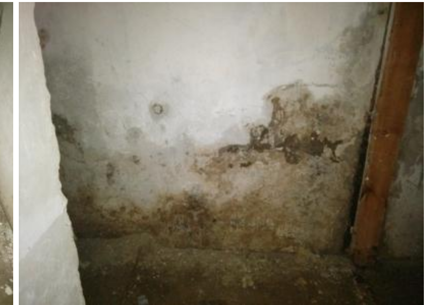
B. Kapilarna vlaga u zidovima
