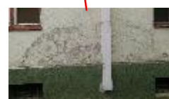
Prisutnost kapilarne vlage u vanjskom zidu prizemlja
