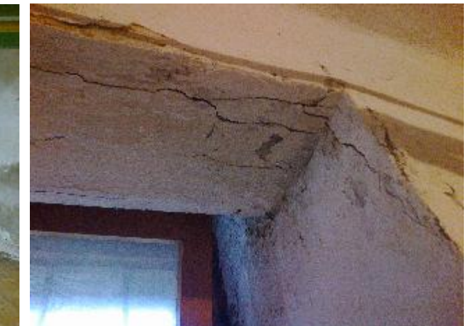
D. Sitne pukotine na nadvoju iznad prozora
