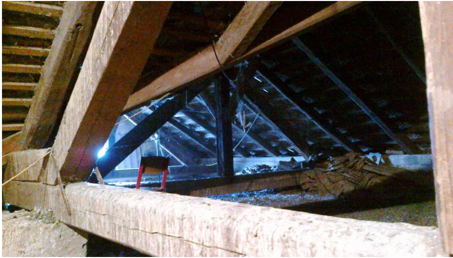
Slika 5.11 Dotrajala krovna konstrukcija
