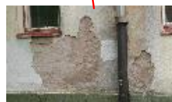
Oštećenje žbuke zbog prisutnosti kapilarne vlage
