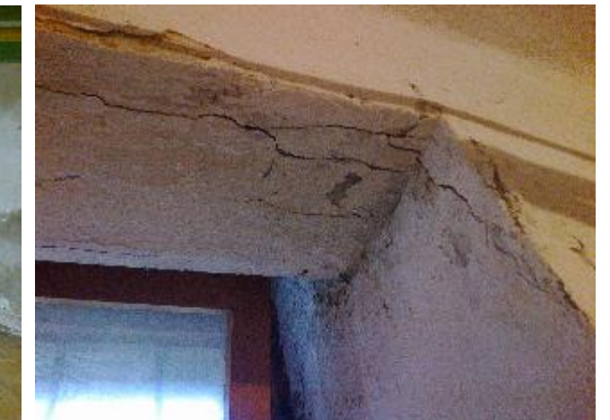
D. Sitne pukotine na nadvoju iznad prozora
