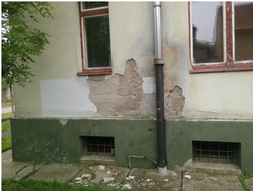
Slika 2.2 Osipanje fasade predmetne zgrade
