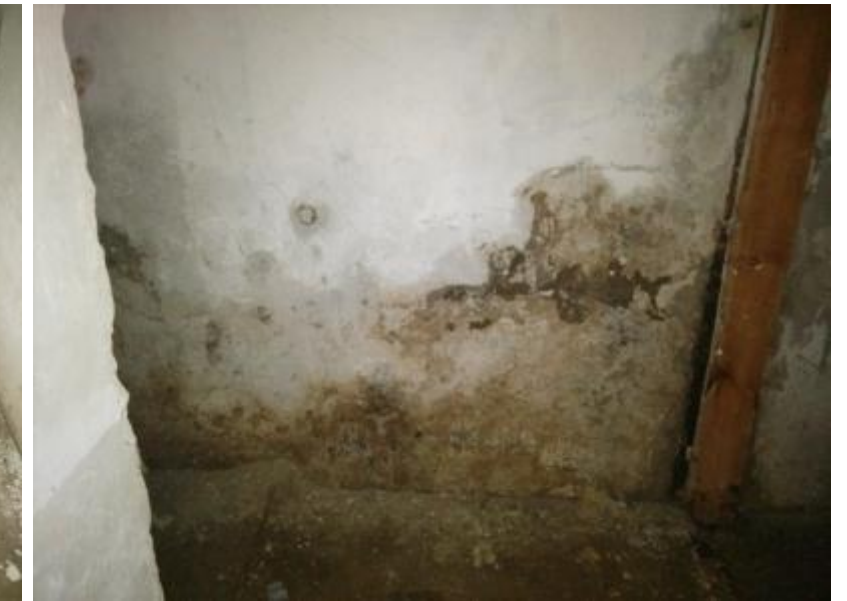
B. Kapilarna vlaga u zidovima
