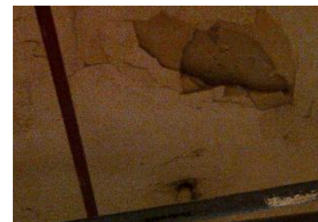
E. Otpadanje žbuke sa stropova podruma
