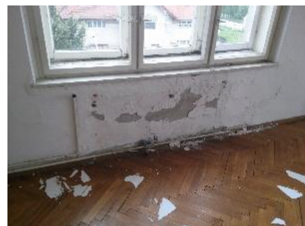
E. Otpadanje žbuke s vanjskog zida ispod prozora
