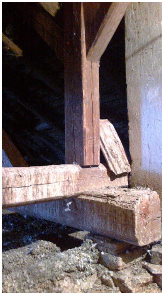
Slika 2.3 Dotrajala krovna konstrukcija predmetne zgrade
