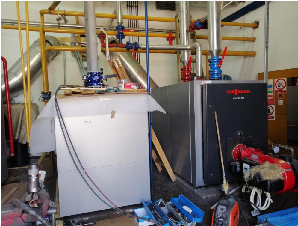
Slika 27. Strojarnica škole s novim kotlom [10]
