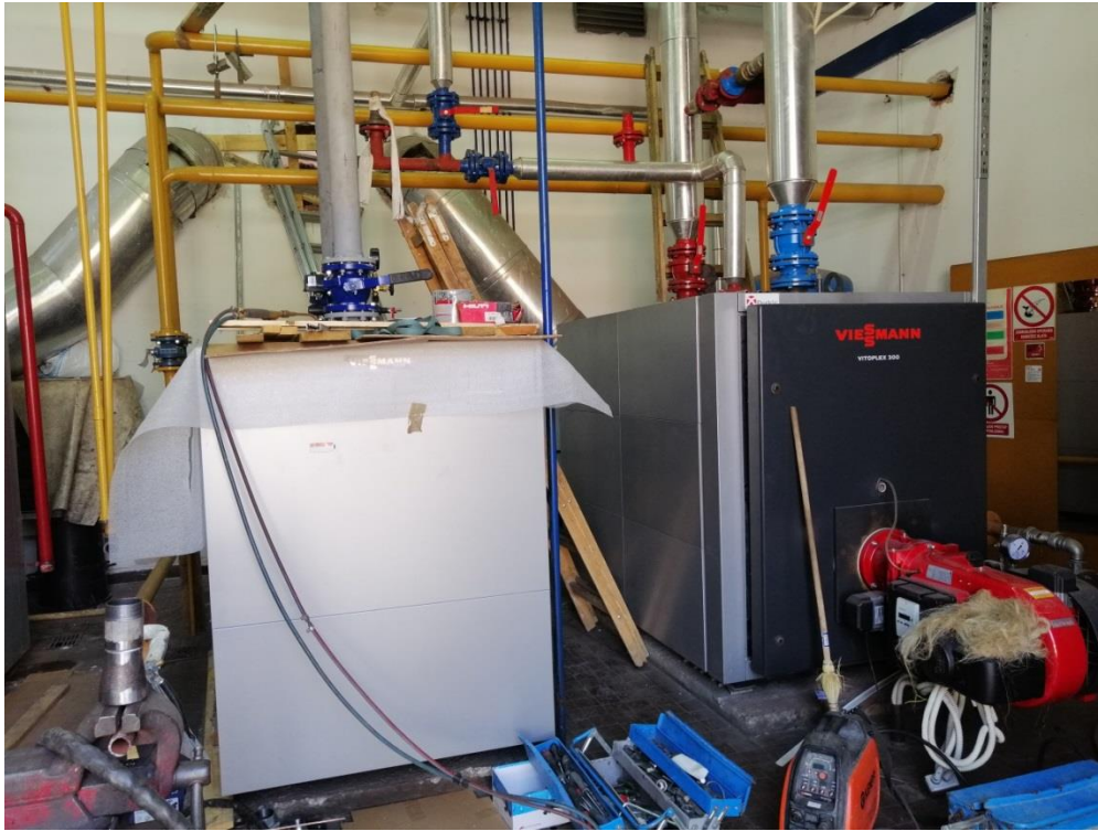
Slika 27. Strojarnica škole s novim kotlom [10]
