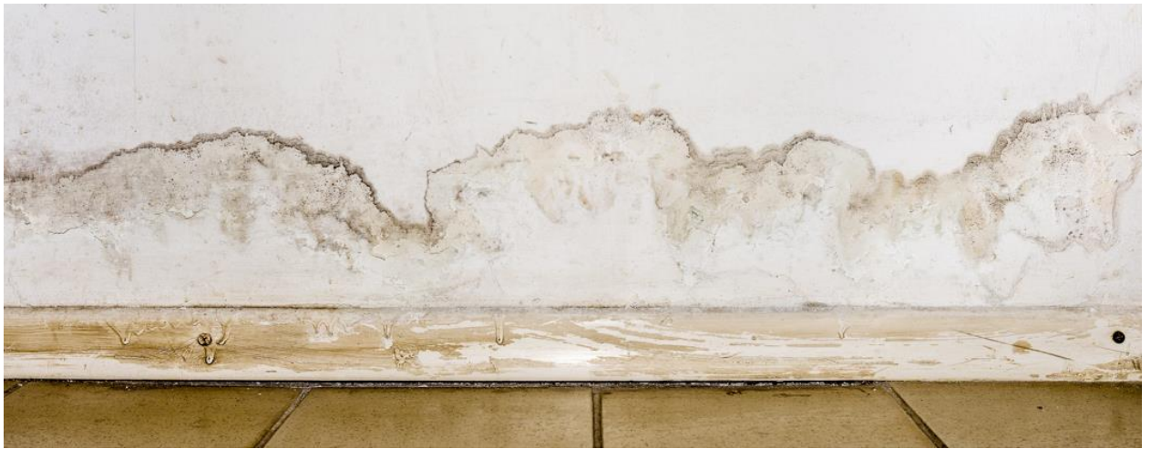
Slika 2.3. Utjecaj vlage na unutrašnji zid
