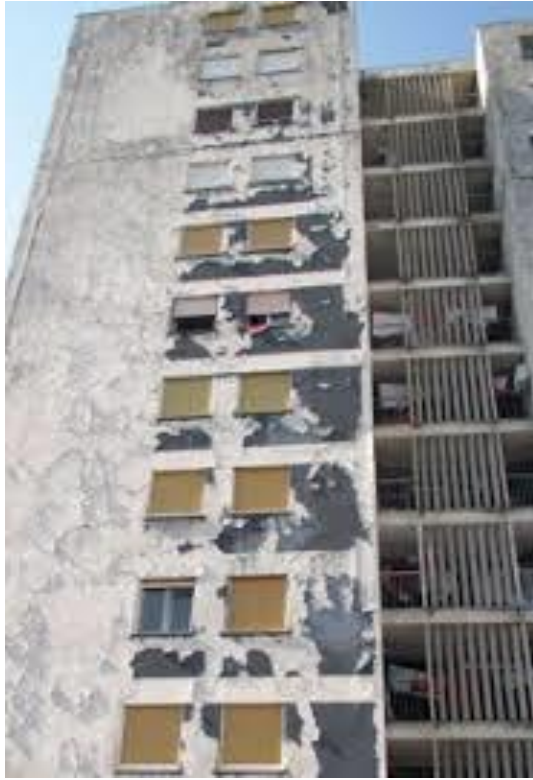
Slika 2.2.1, Propadanje građevine od djelovanja vanjskih utjecaja
