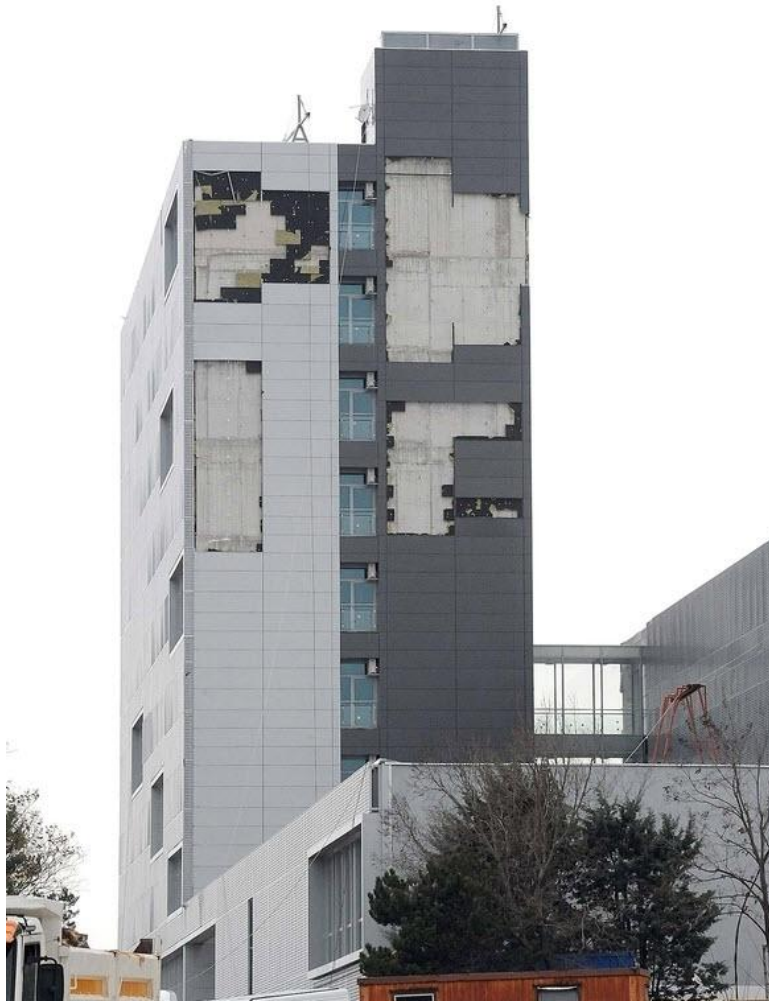
Slika 2.10. Oštećenja uslijed jake bure, Trsat, Rijeka, izvor http://www.lokalpatrioti-rijeka.com/forum
