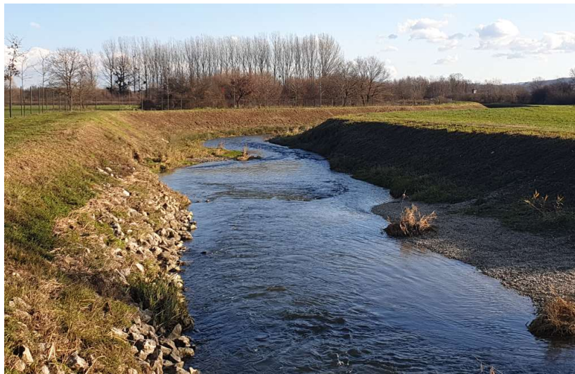
Slika 4.12 Stara sanacija pokosa kamenom – znak kontinuirane erozije na predmetnoj poziciji; vidljive manje erozije u saniranom segmentu [2]
