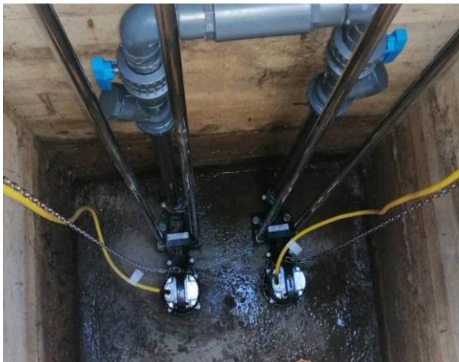
Slika 4.6. Primjer crpne stanice [11]
