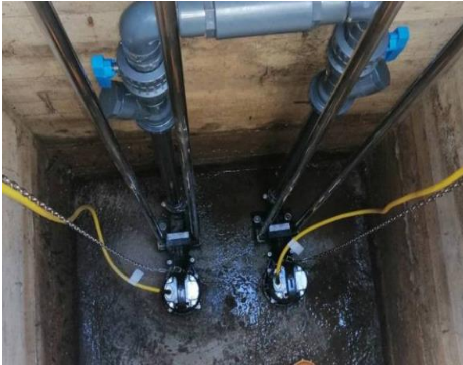
Slika 4.6. Primjer crpne stanice [11]
