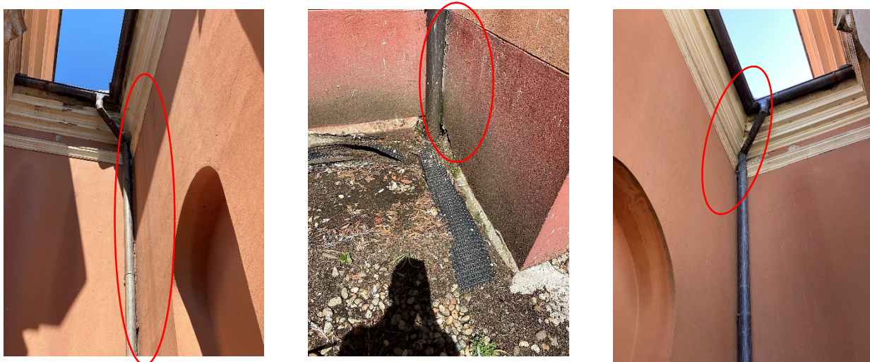
Slika 8.1. Vanjska oštećenja na spoju južne bočne kapele
