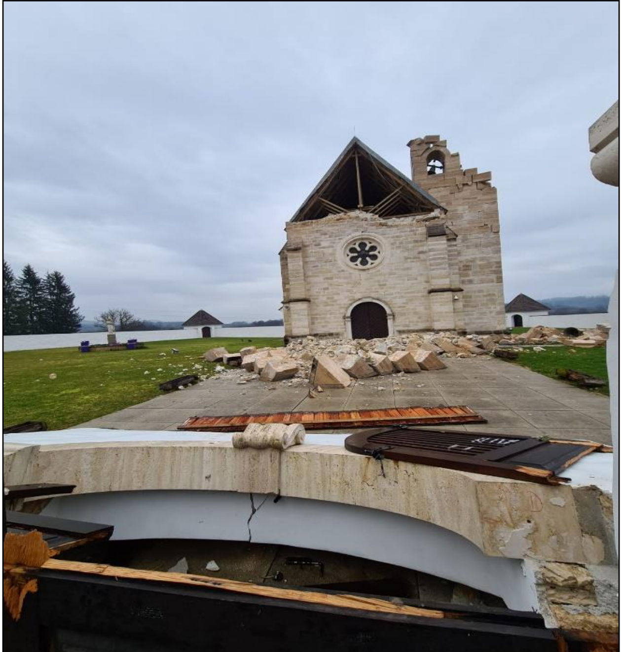
Slika 108. Razrušena crkva nakon potresa
