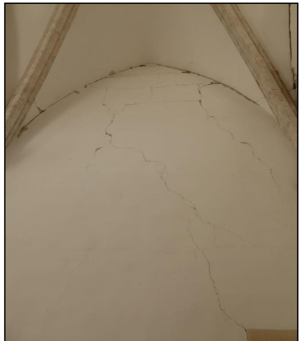
Slika 116. Pukotine na zidu crkve
