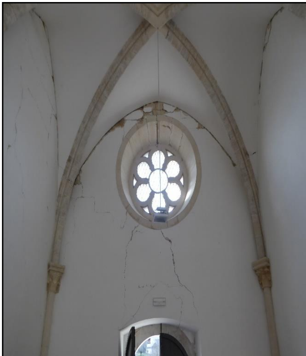
Slika 115. Unutarnja slika oštećenja zapadnog zida
