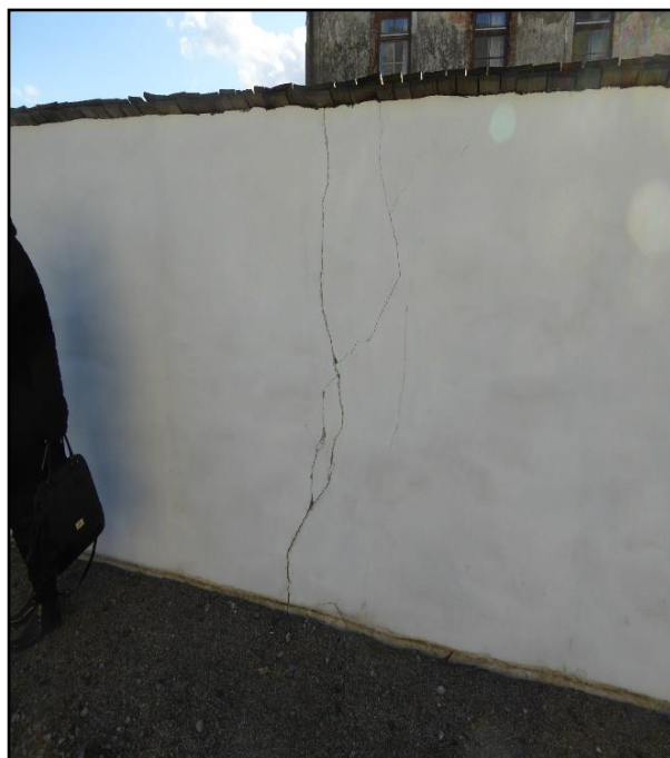
Slika 114. Pukotine na južnom zidu cinktora
