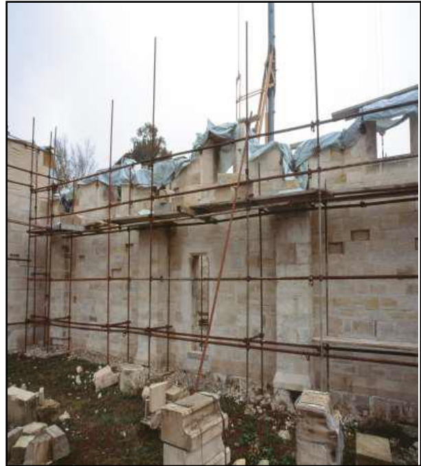
Slika 52. Detalj oštećenja zamjenskog kamena (2)
