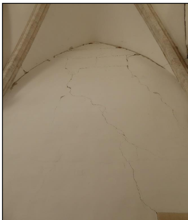
Slika 116. Pukotine na zidu crkve
