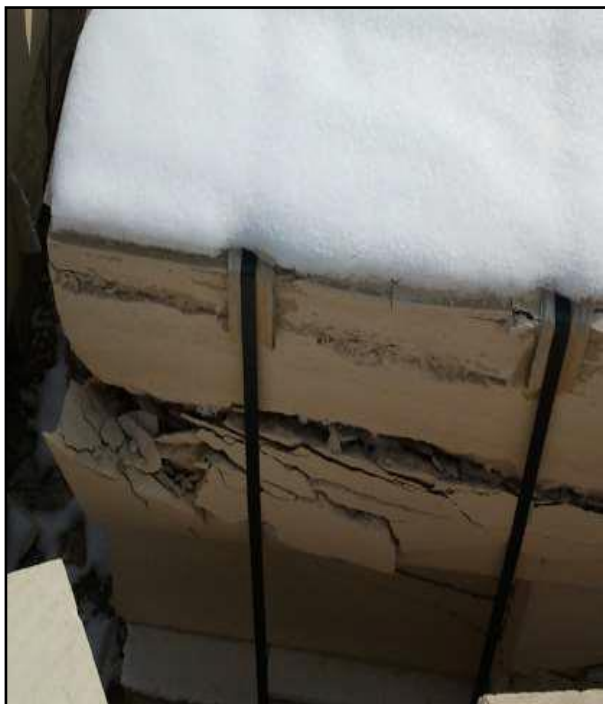
Slika 49. Detalj oštećenja lokalnog kamena (1)
