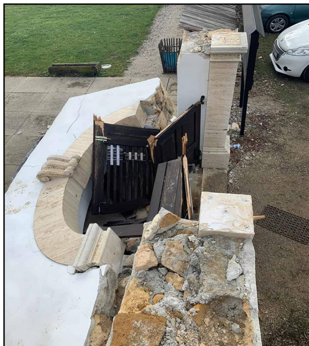
Slika 113. Razrušena ulazni portal
