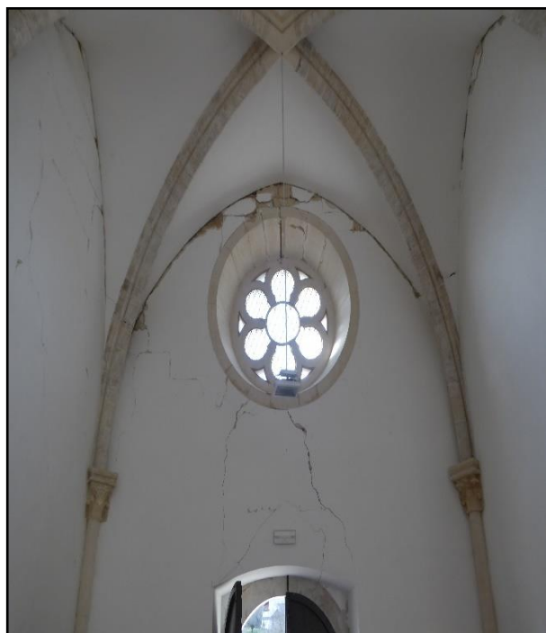
Slika 115. Unutarnja slika oštećenja zapadnog zida
