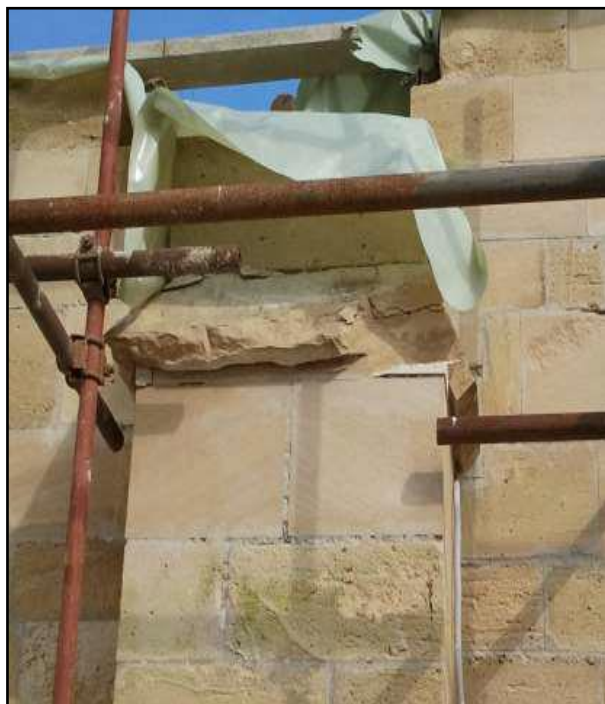
Slika 50. Detalj oštećenja lokalnog kamena (2)
