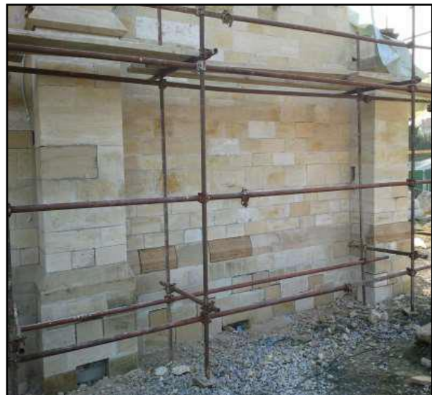
Slika 54. Detalj oštećenja kamena plivita (2)
