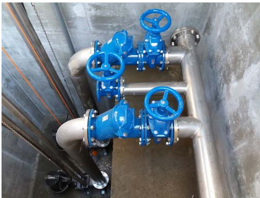
Slika 4.4. Primjer crpne stanice sa crpkama [20]
