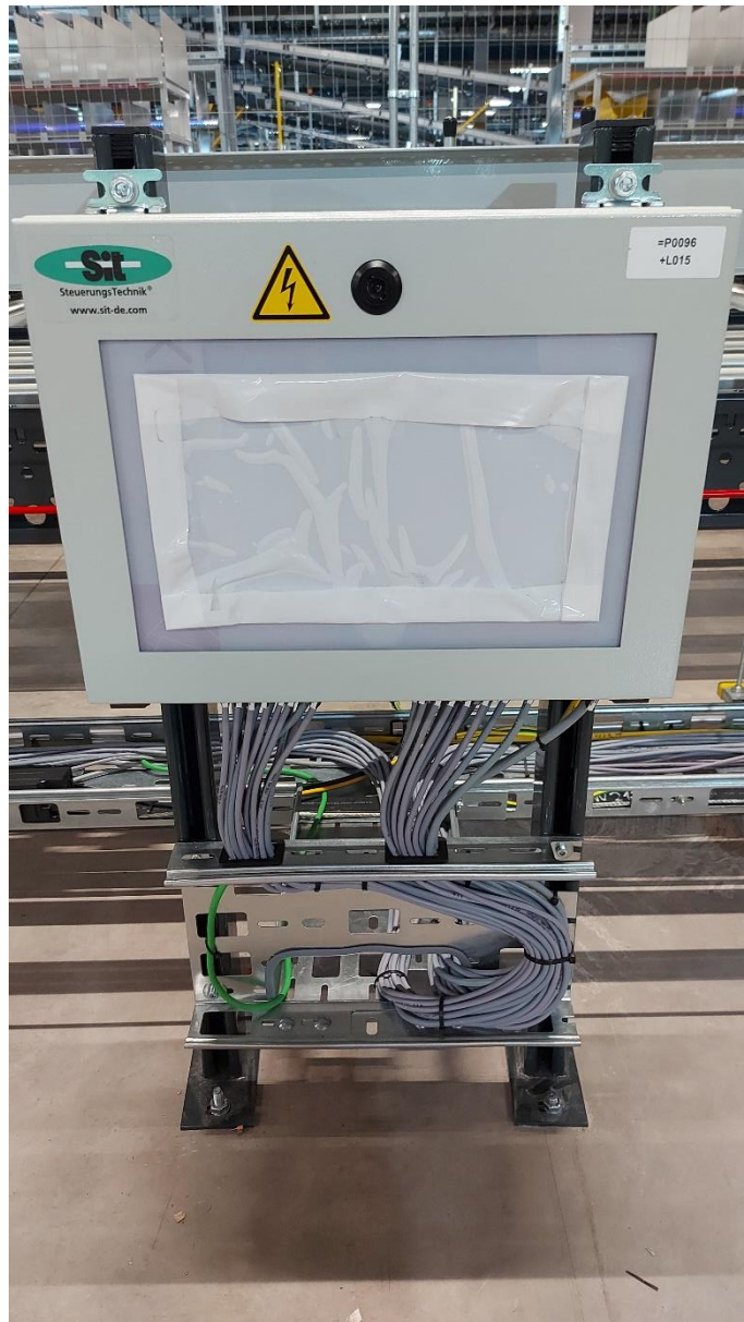
Slika 6.21 Izgled lokalnog ormara za sigurnosne tipke, također se vidi i zeleni profinet kabel
