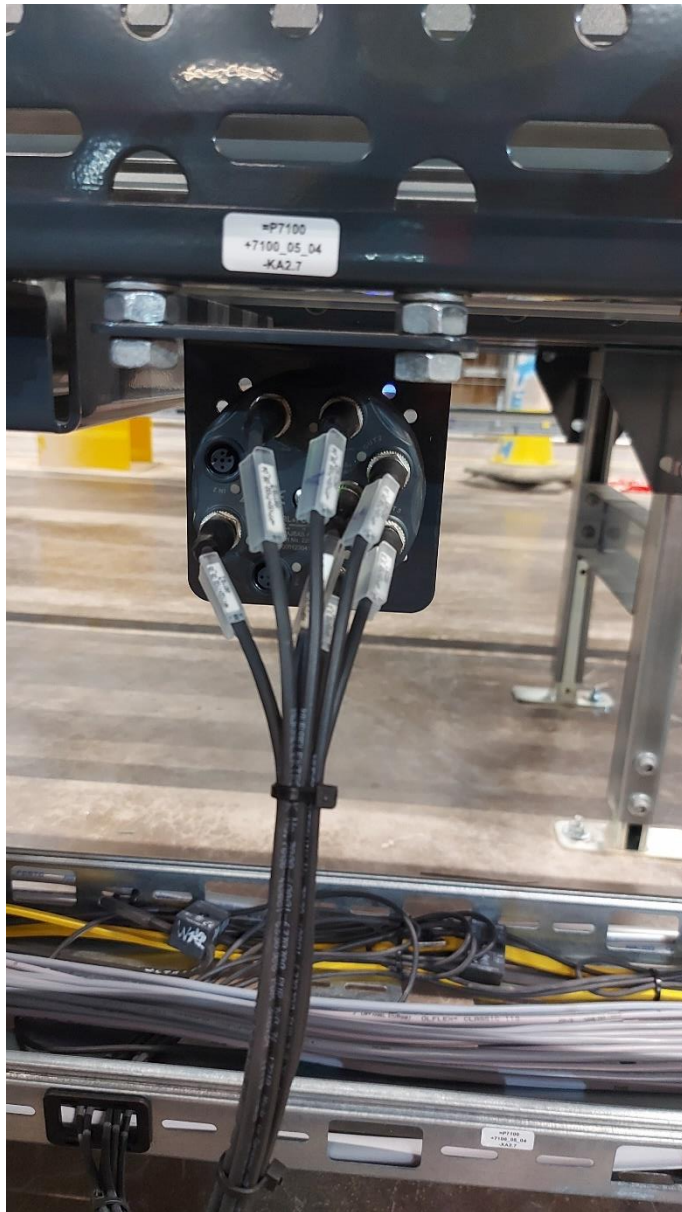
Slika 8.1 Primjer oznaka na kabelima, te na kanalu i transportnom kanalu
