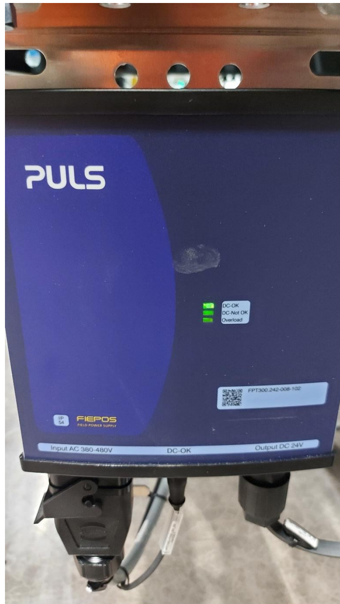
Slika 7.7 izgled transformacijskog uređaja
