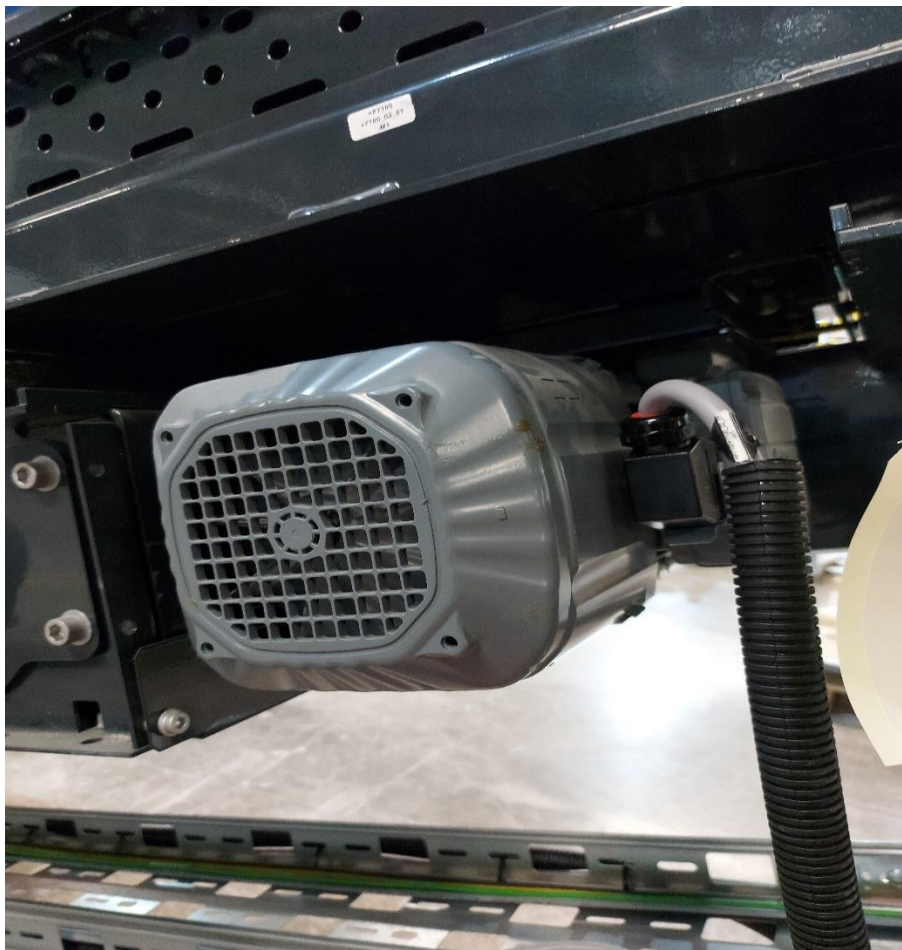
Slika 6.3 Asinkroni motor te motorni kabel
