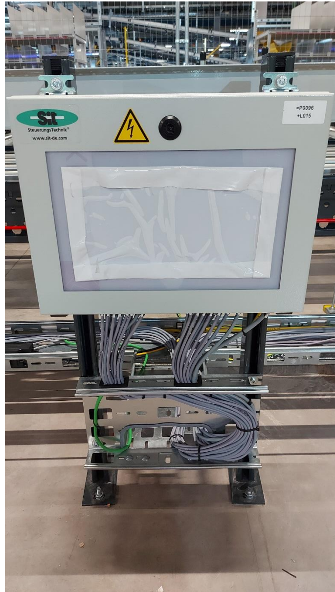
Slika 6.21 Izgled lokalnog ormara za sigurnosne tipke, također se vidi i zeleni profinet kabel
