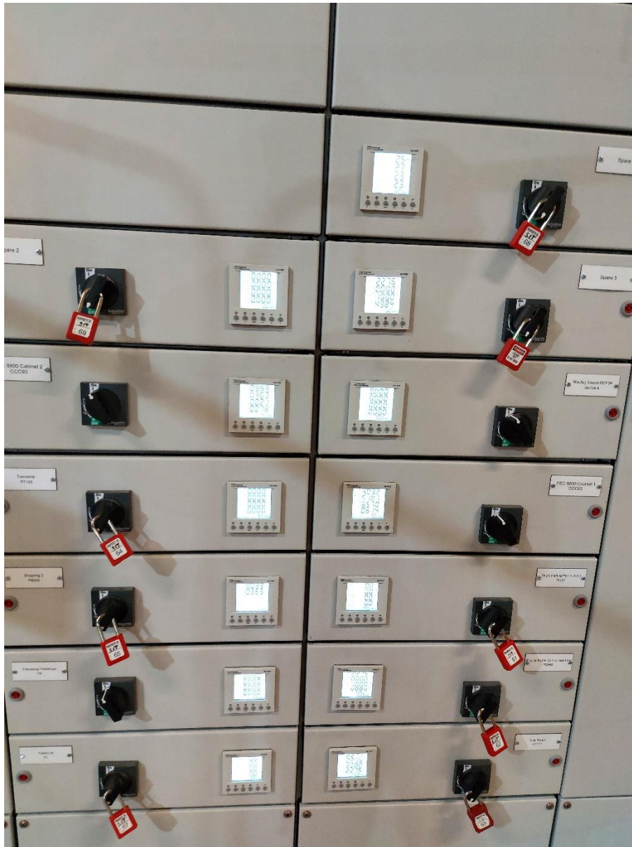
Slika 6.18 Glavni razvodni ormar
