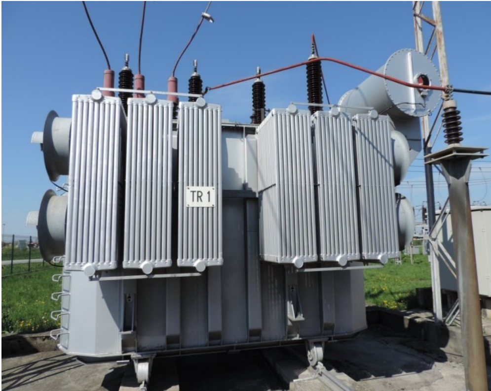
Slika 5.6 Transformator "Trokut" Čakovec
