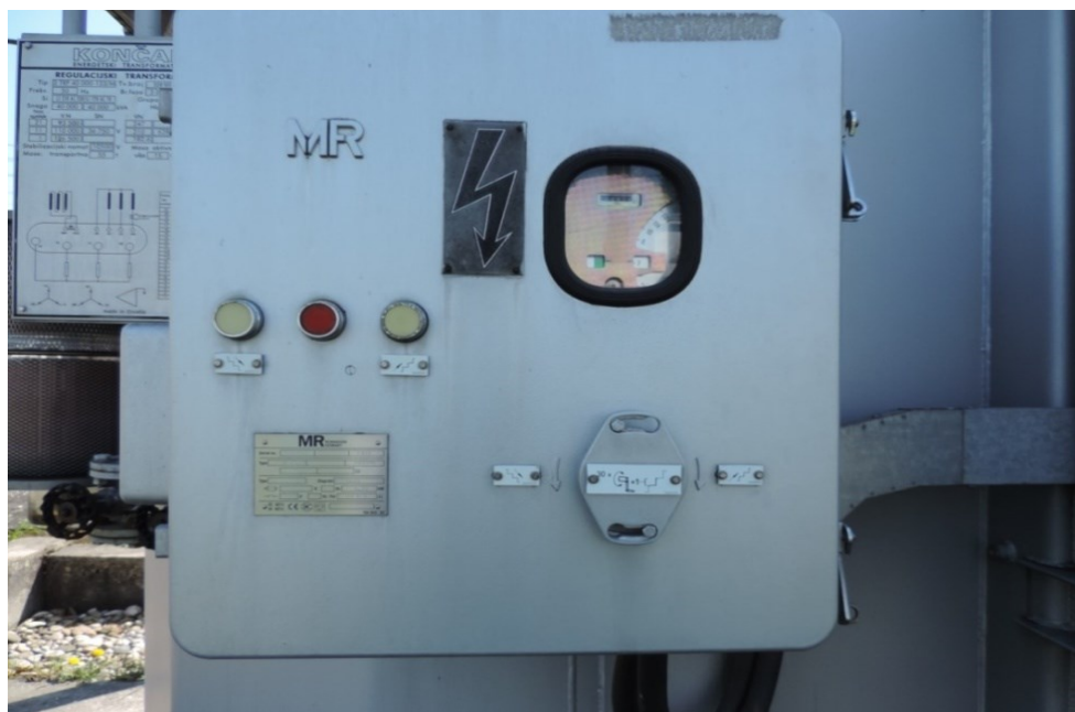
Slika 5.7 Ormar automatske regulacija transformatora "Trokut" Čakovec
