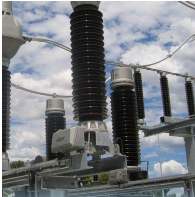
Slika 2.13 Mjerni transformator 110 kV [5]
