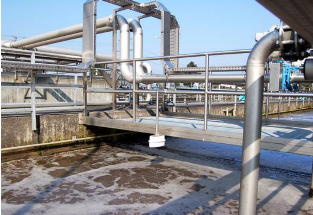
Slika 24. Mjerenje pomoću uređaja SQ-R Flow Meter na uređaju za pročišćavanje otpadnih voda [11]
