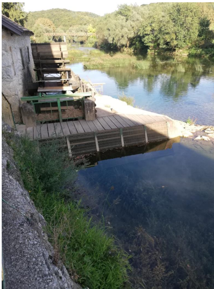
Slika 16. Zaštitne ulazne rešetke [3]
