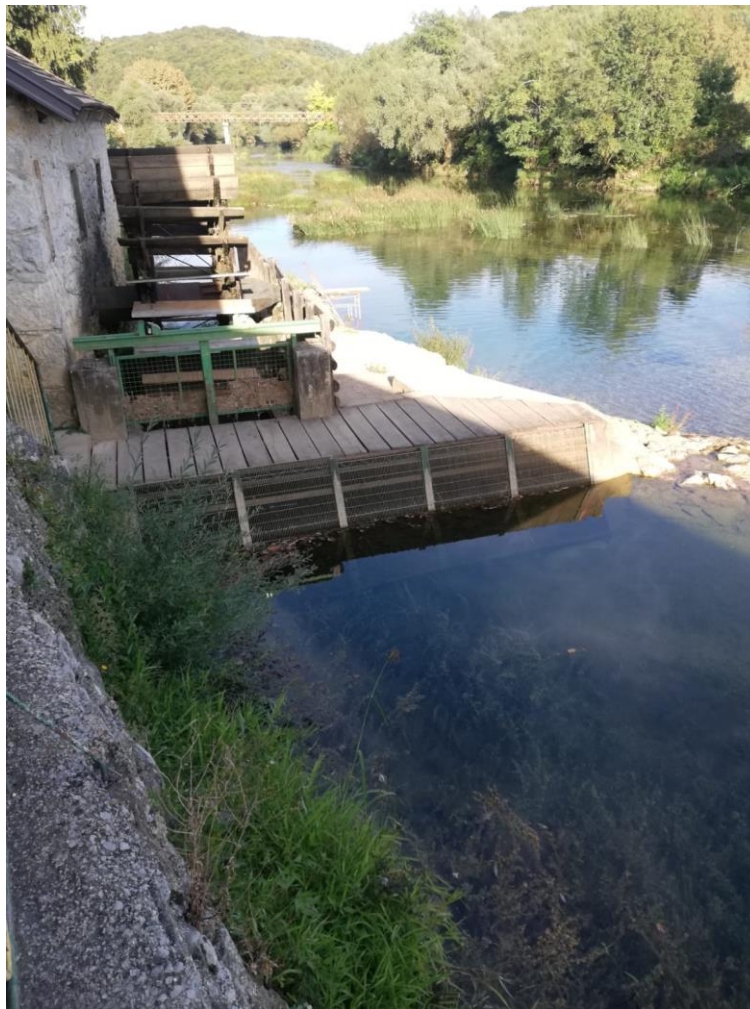
Slika 16. Zaštitne ulazne rešetke [3]
