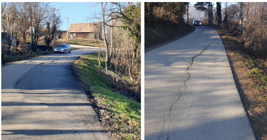
Slika 4.4.: Primjeri pukotine u kolniku ceste nakon manje sanacije [3]
