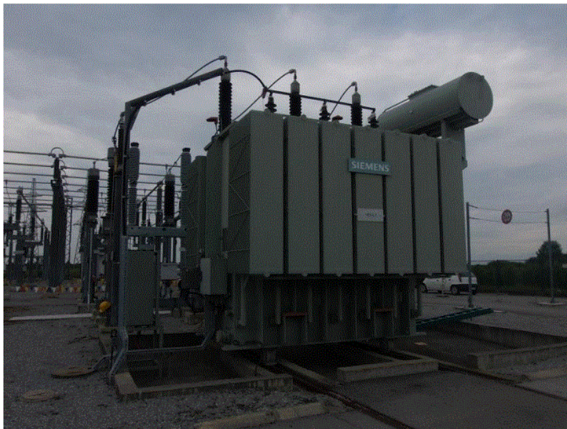
Slika 4.2 Regulacijska prigušnica na 110 kV sabirnici u TS 400/110 kV Ernestinovo [12]
