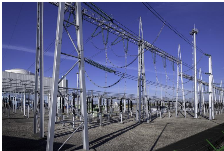
Slika 2.6 Vanjsko rasklopno postrojenje 110 kV [5]
