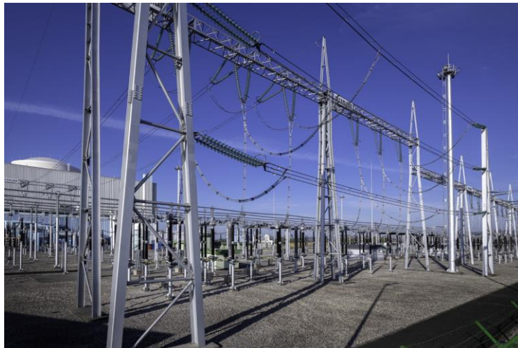
Slika 2.6 Vanjsko rasklopno postrojenje 110 kV [5]
