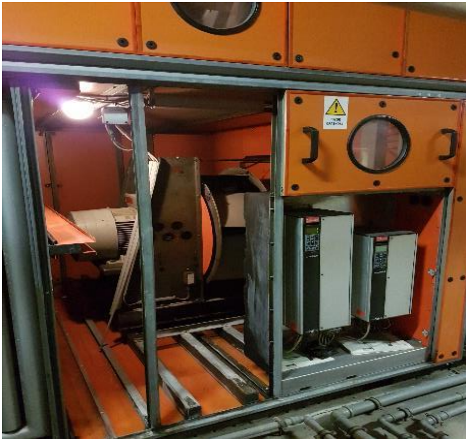
Slika 3.10 Klima uređaj za odvlaživanje, ventilaciju i grijanje (vlastiti izvor)
