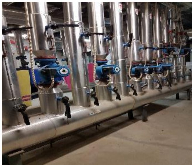
Slika 3.8 Cirkulacijske crpke na razdjelniku ogrjevnog medija (vlastiti izvor)
