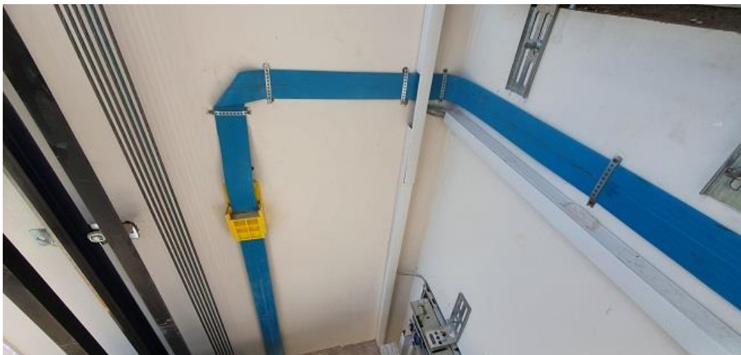
Slika 24. Električne instalacije u voznome oknu [3]
