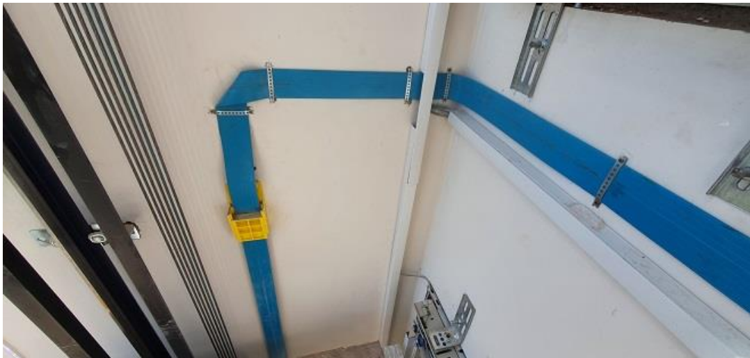
Slika 24. Električne instalacije u voznome oknu [3]
