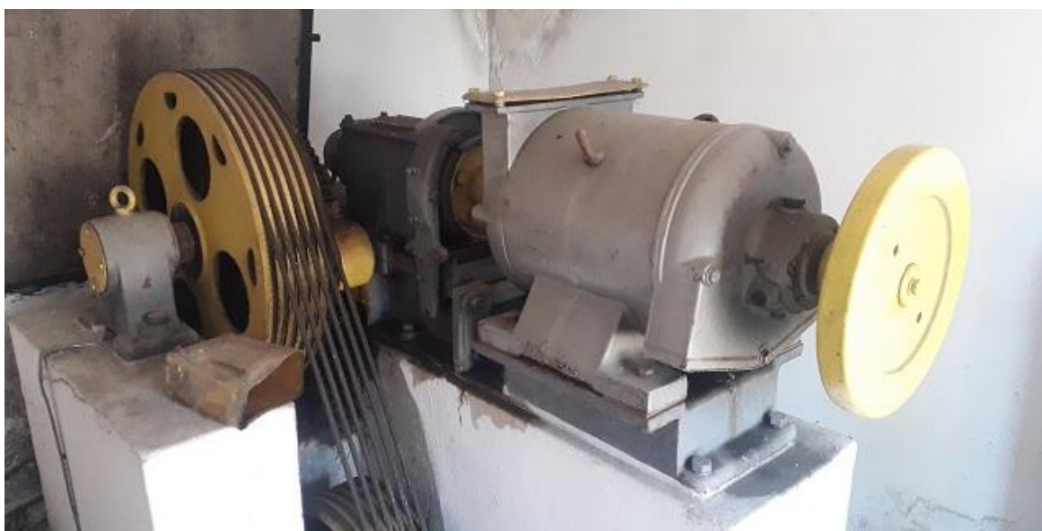
Slika 1. Elektromotor s reduktorom (skladište u Varaždinu)
