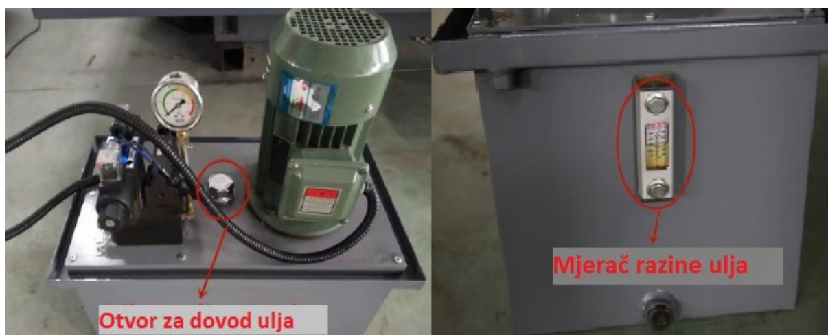
Slika 25 Dovod ulja hidrauličke stanice [10]
