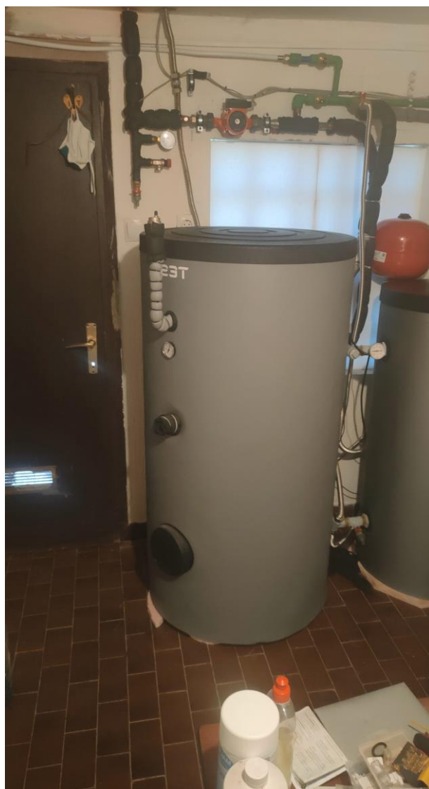
Slika 3.9 Akumulacija tople potrošne vode od 400 litara
