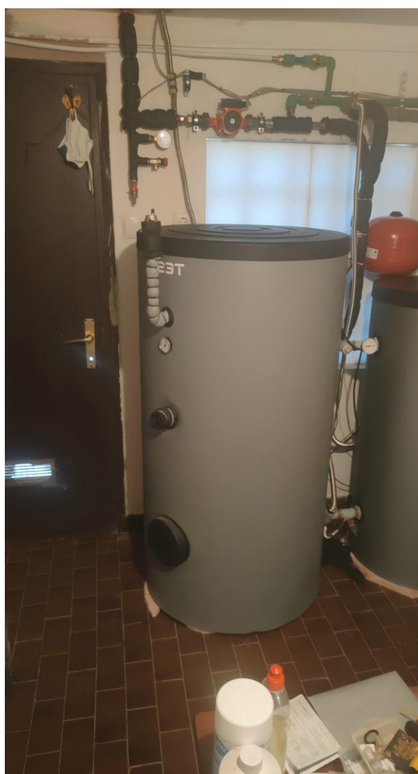
Slika 3.9 Akumulacija tople potrošne vode od 400 litara
