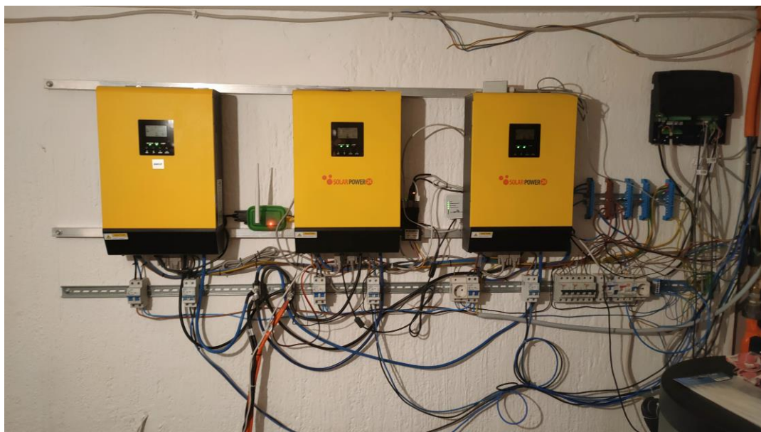
Slika 3.7 Solarni pretvarači u trofaznom sustavu
