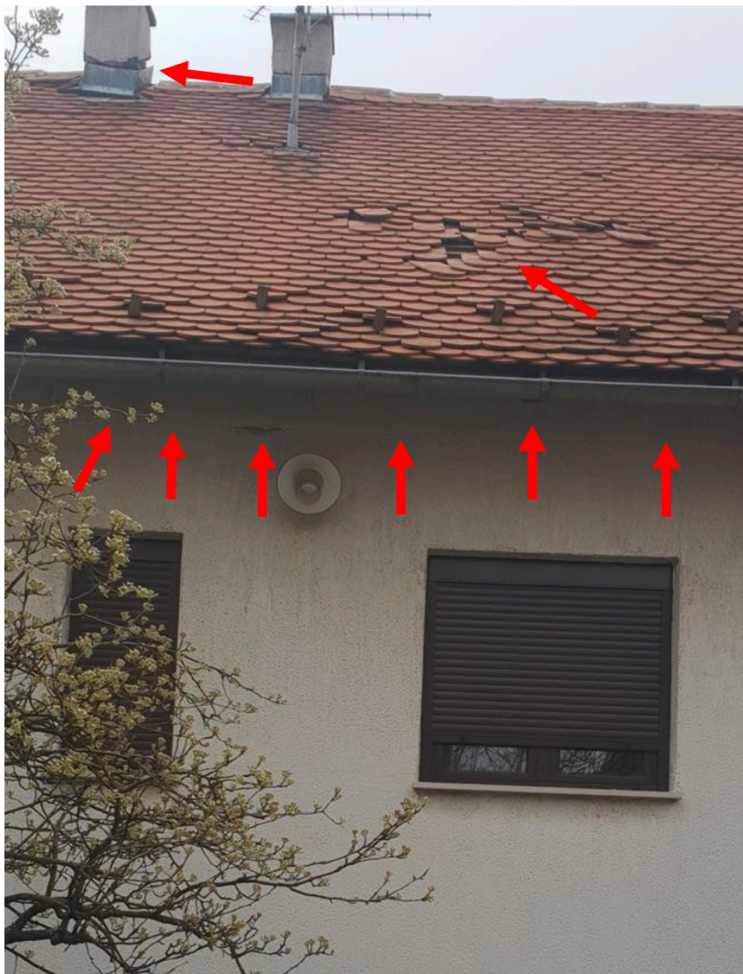
Foto 5. Pukotina vanjskog zida na poziciji MK iznad kata, oštećeni dimnjak i pokrov (S pročelje) OŠTEĆENJA TIPA 2 (MK – međukatna konstrukcija)
