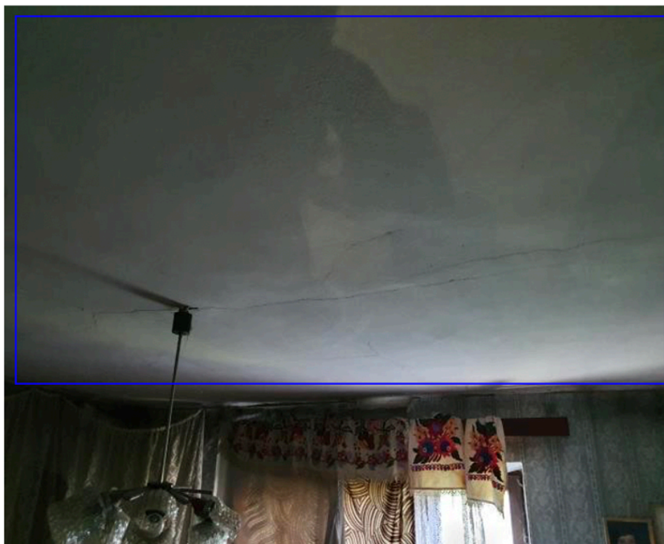
Foto 21. Pukotine podgleda stropa iznad kata OŠTEĆENJA TIP 1
