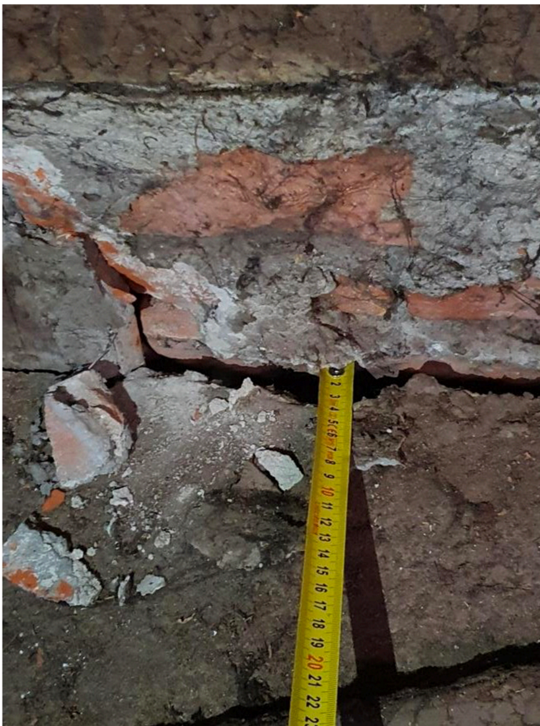
Foto 13. Pukotina na spoju MK (pod tavana) i vanjskog zida (J zid), izmjeren max pomak od cca 3cm OŠTEĆENJA TIP A 2
