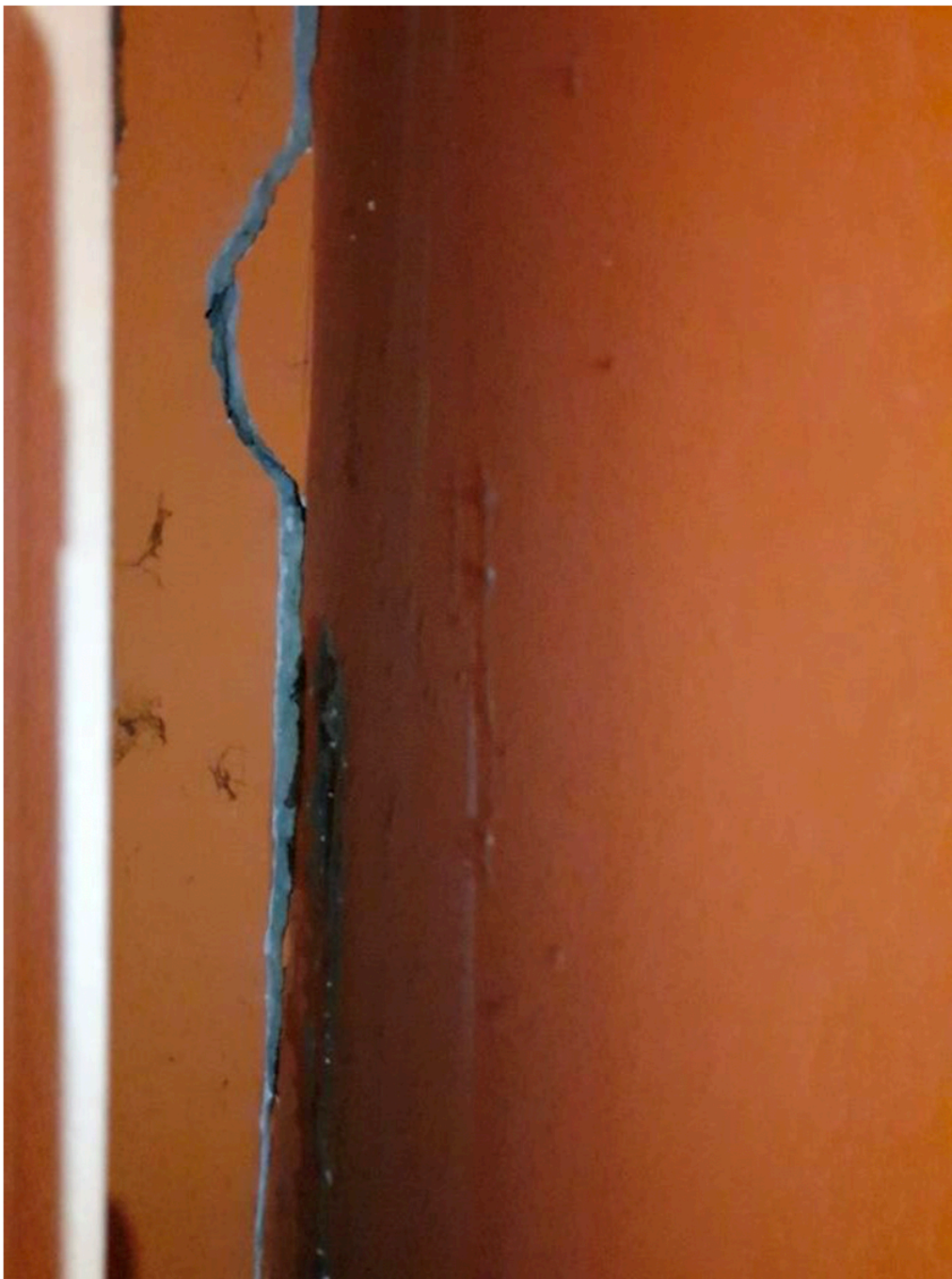
Foto 16. Vertikalna pukotina na spoju unutarnjeg i vanjskog(zida (J zid) – OŠTEĆENJE TIPA 2
