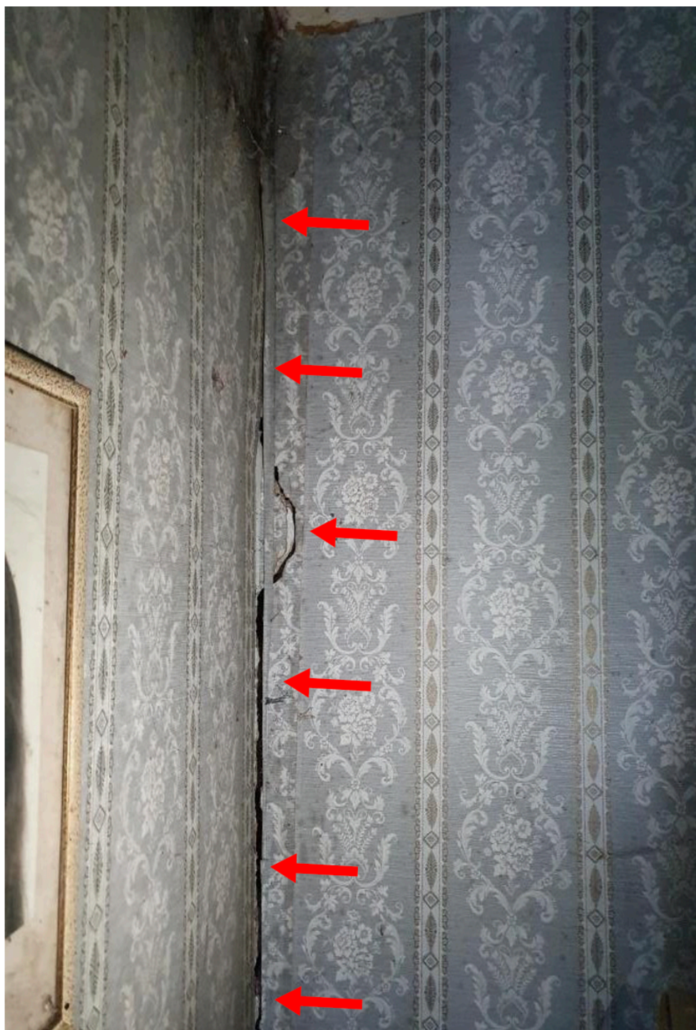
Foto 20. Vertikalna pukotina na spoju unutarnjeg i vanjskog zida (J zid) – OŠTEĆENJE TIP A 2
