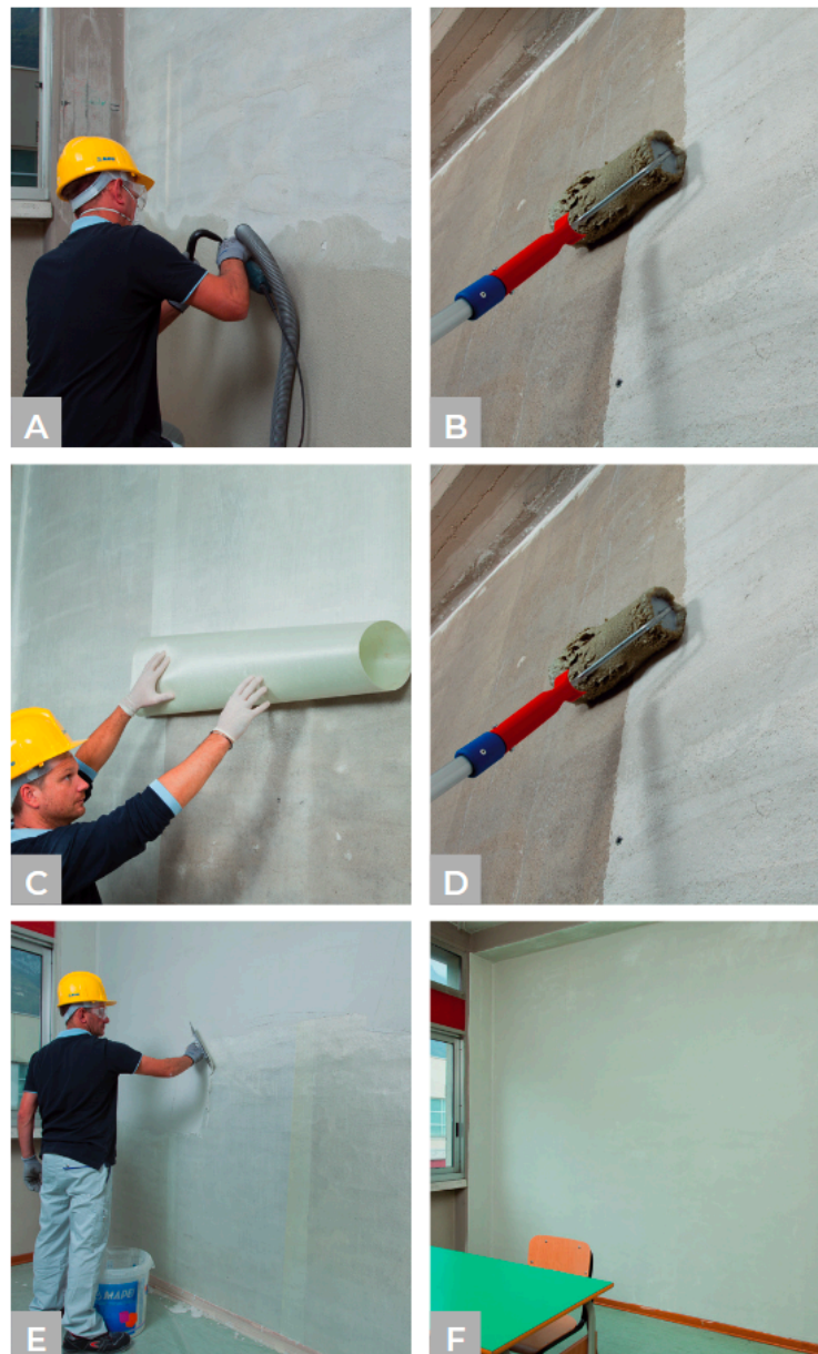
Slika 48. Prikaz postupka ojačanja – MAPEWRAP EQ sustav (izvor: brošura Mapei, Protupotresna ojačanja konstrukcija) [16]
