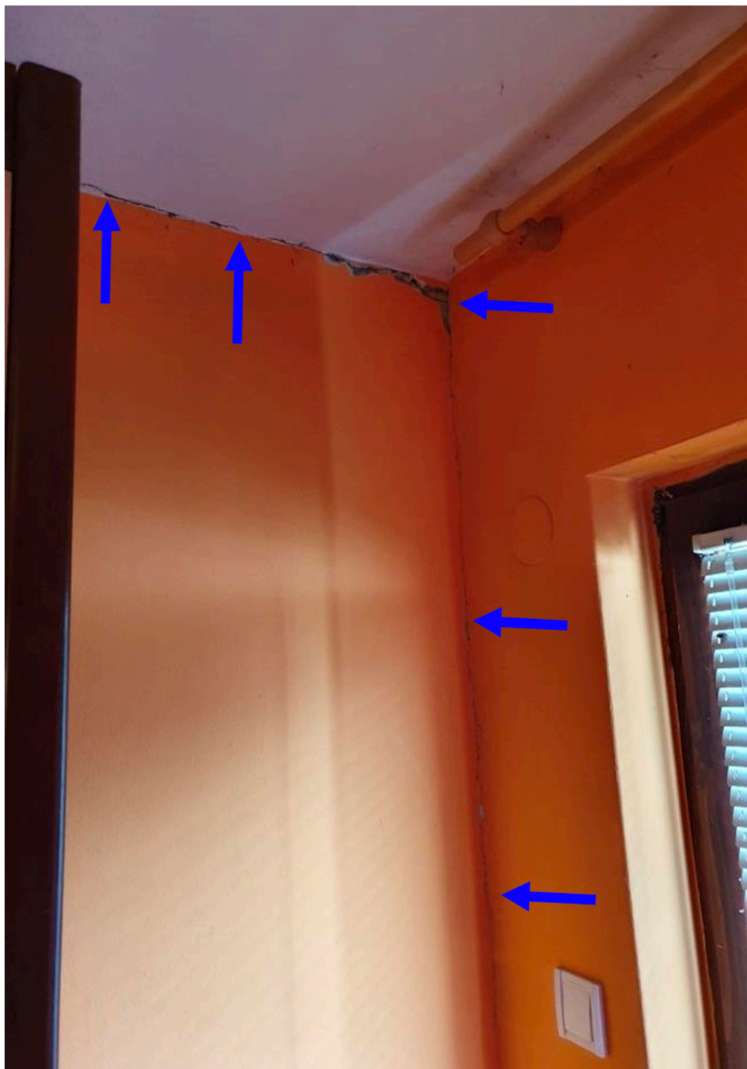
Foto 23. Pukotina na spoju unutarnjeg zida i MK kata, te unutarnjeg i vanjskog zida - OŠTEĆENJE TIP 1(MK – međukatna konstrukcija)
