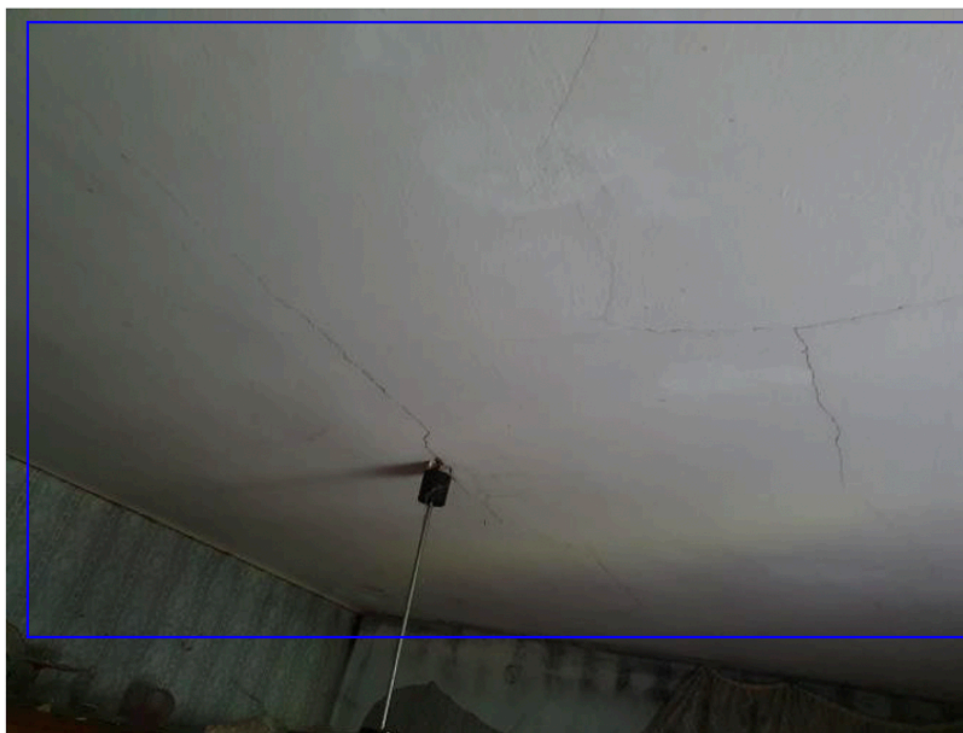
Foto 22. Pukotine podgleda stropa iznad kata OŠTEĆENJA TIP 1
