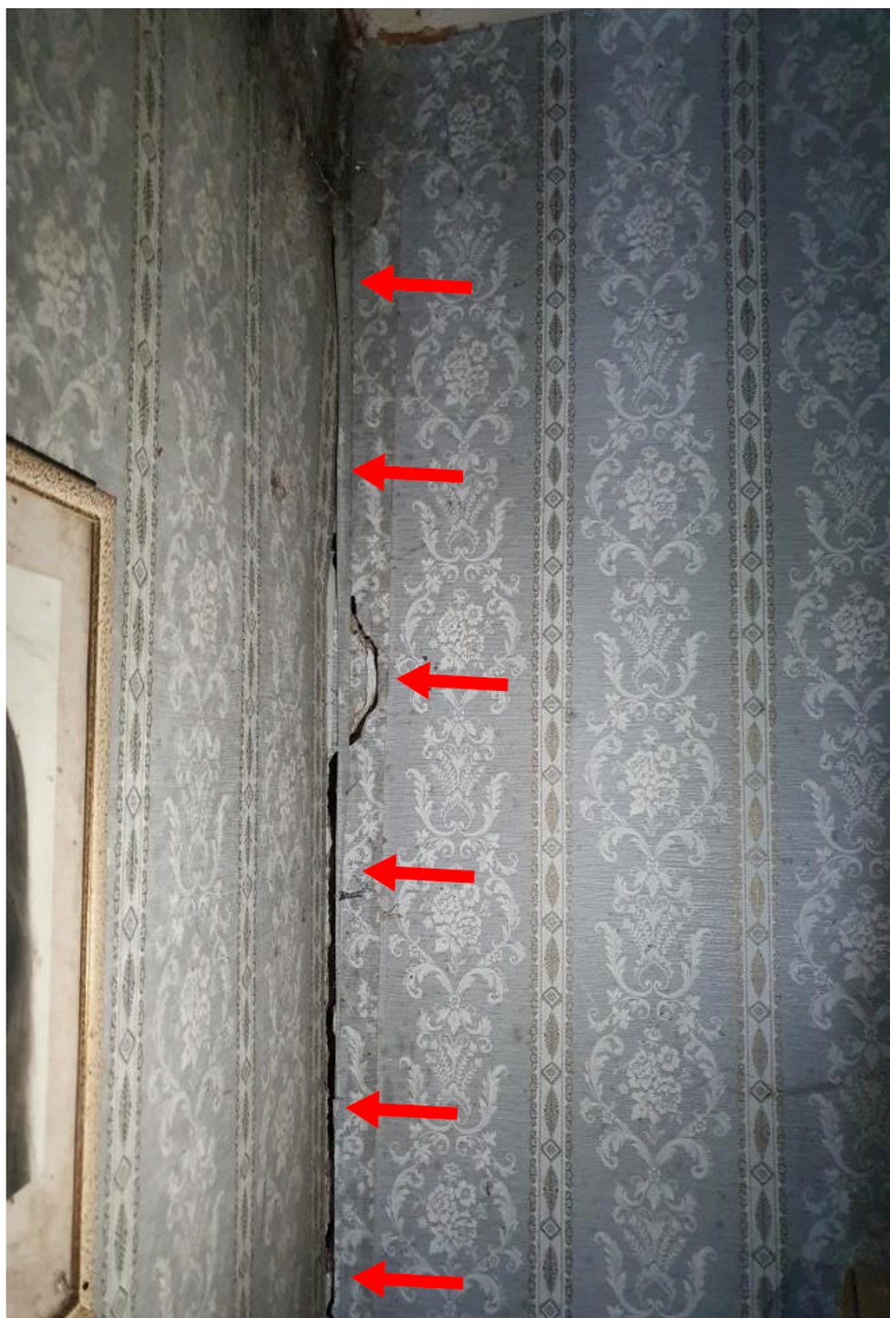
Foto 20. Vertikalna pukotina na spoju unutarnjeg i vanjskog zida (J zid) – OŠTEĆENJE TIP A 2
