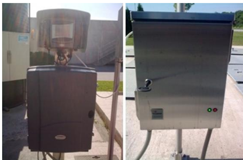
Slika 4.8. Analizator fosfora na UPOV Koprivnica
