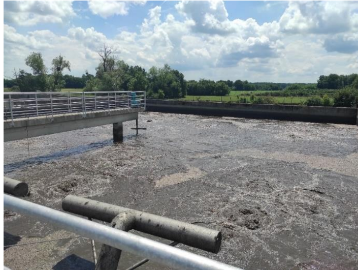
Slika 4.9. Izgled SBR reaktora prilikom aeracije
