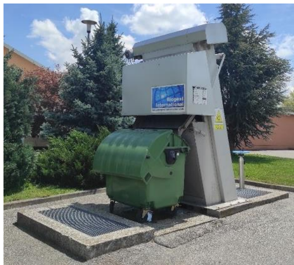
Slika 4.4. Gruba rešetka na UPOV Koprivnica
