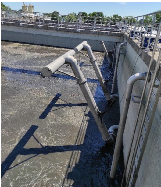
Slika 4.11. Izgled uređaja za odvodnju pročišćene vode
