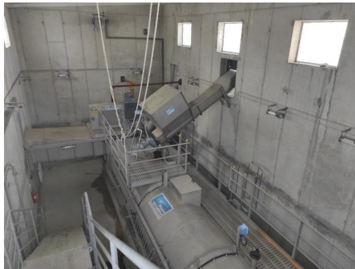
Slika 4.5. Vertikalni pjeskolov i mastolov na UPOV Koprivnica
