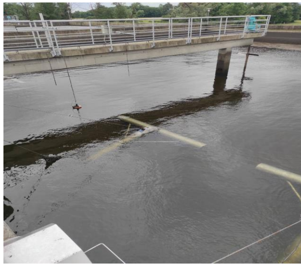
Slika 4.10. Izgled SBR reaktora prilikom faze sedimentacije
