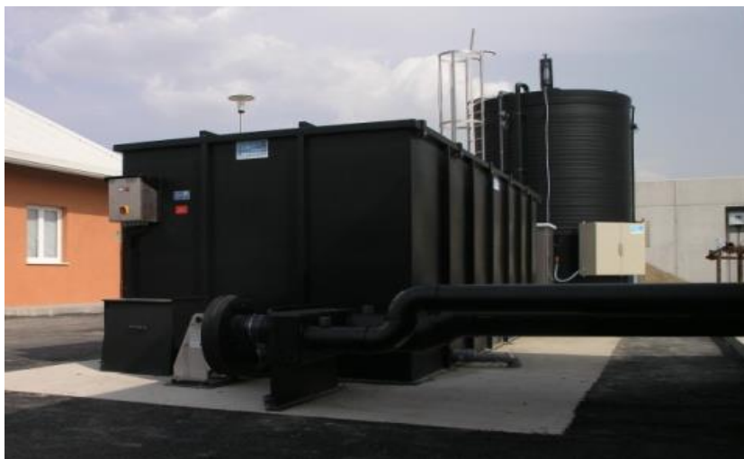
Slika 4.14. Uređaj za pročišćavanje zraka na UPOV Koprivnica
