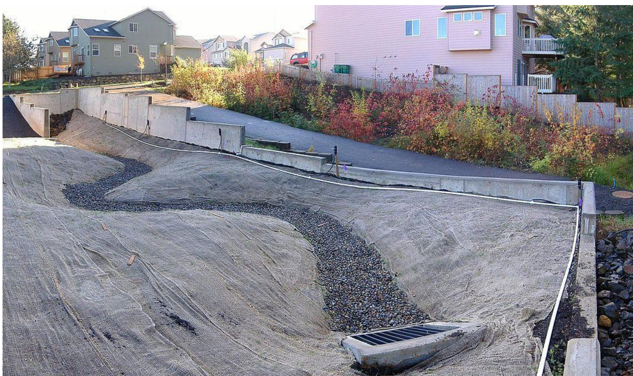
Slika 13. Kanal dizajniran da koncentrira i odvedu oborinske vode dok uklanja ostatke i onečišćenje
