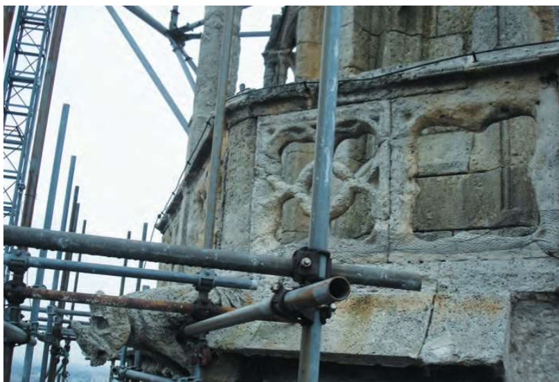
Slika 3. Oštećenje Zagrebačke katedrale nastalo zbog kiselih kiša [31]
