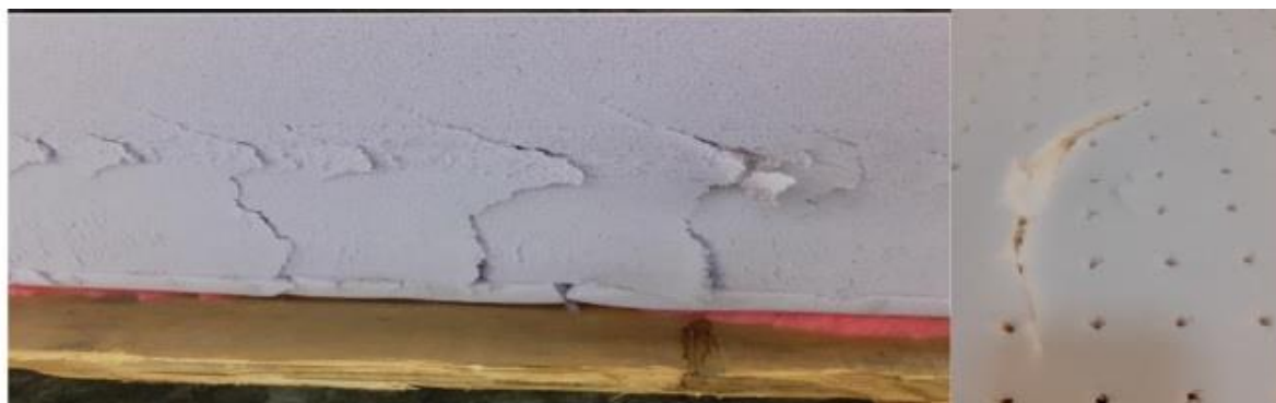
Slika 3.1.2 Primjer oštećenog materijala [8]
