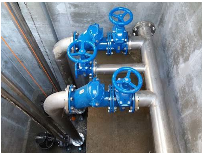
Slika 4.4. Primjer crpne stanice sa crpkama [20]
