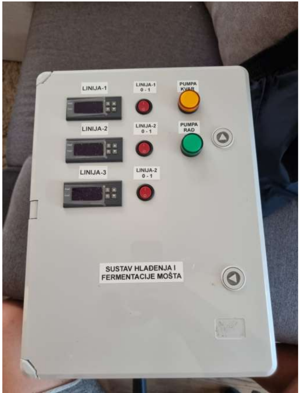
Slika 4.3. Rashladni sustav smješten u kućište
