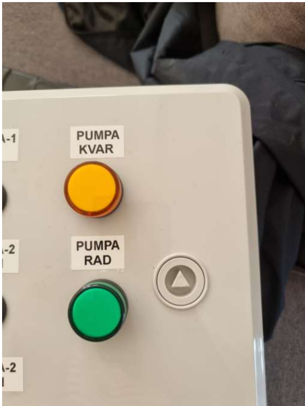
Slika 5.4. Indikatori u rashladnom sustavu
