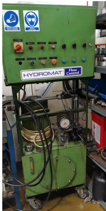
Slika 5.59; Hidraulički agregat [autor - 20.05.2022.]
